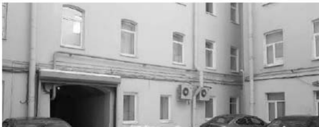
32. Дом жилой с дворовыми флигелями (в составе «Дом Пашковой Е.П. (посольство Франции)»). Набережная Кутузова, дом 10, литера А. Дворовые фасады. Фото мест установки оборудования и кабельных трасс. Штиглиц М.С. 10.01.2022.
