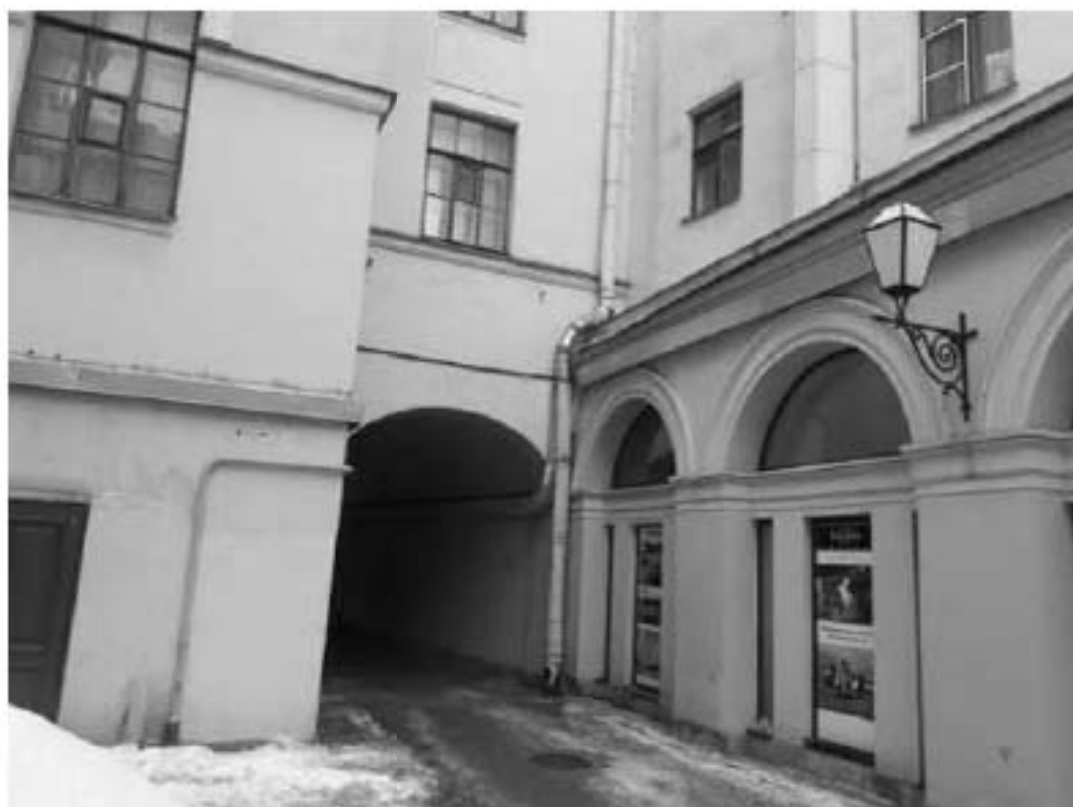
18. Корпус квартирный с флигелями (в составе «Капелла Придворная певческая»). Большая Конюшенная улица, дом 11, литера Б. Дворовые фасады. Фото мест установки оборудования и кабельных трасс. Штиглиц М.С. 10.01.2022.
