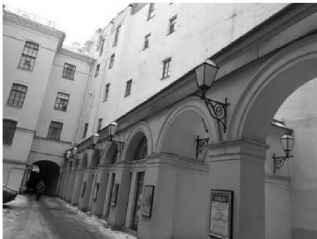
17. Корпус квартирный с флигелями (в составе «Капелла Придворная певческая»). Большая Конюшенная улица, дом 11, литера Б. Дворовые фасады. Фото мест установки оборудования и кабельных трасс. Штиглиц М.С. 10.01.2022.
