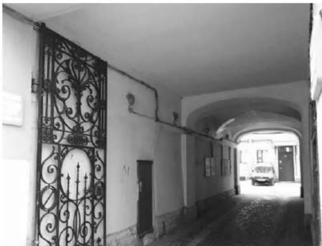
5. Дом Д.И. Тырлова. Невский пр., д. 119, литера А. Арочный проезд. Фото мест установки оборудования и кабельных трасс. Штиглиц М.С. 10.01.2022.
