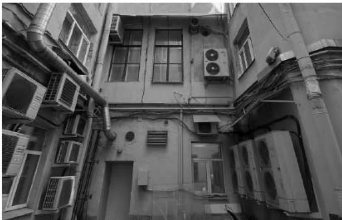
22. Дом Г.И. Гансена. Малая Конюшенная улица, дом 16/26, литера А. Дворовые фасады. Фото мест установки оборудования и кабельных трасс. Штиглиц М.С. 10.01.2022.
