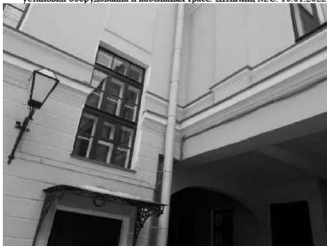
42. Главное здание (концертный зал с учебными флигелями) (в составе «Капелла Придворная певческая»). Набережная реки Мойки, дом 20, литера А. Дворовые фасады. Фото мест установки оборудования и кабельных трасс. Штиглиц М.С. 10.01.2022.
