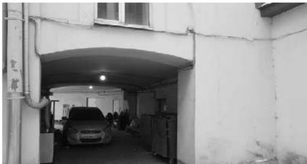
35. Дом жилой с дворовыми флигелями (в составе «Дом Пашковой Е.П. (посольство Франции)»). Набережная Кутузова, дом 10, литера А. Дворовые фасады. Фото мест установки оборудования и кабельных трасс. Штиглиц М.С. 10.01.2022.
