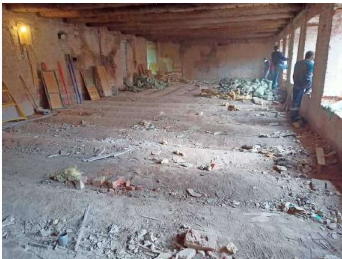
4. Помещения №1-5 кв. №48-49 объекта культурного наследия регионального значения «Дом по 2-ой Советской ул. с дворовым флигелем», расположенного по адресу: г. Санкт-Петербург, 2-ая Советская ул., 27/2, литера А. 04.05.2022
