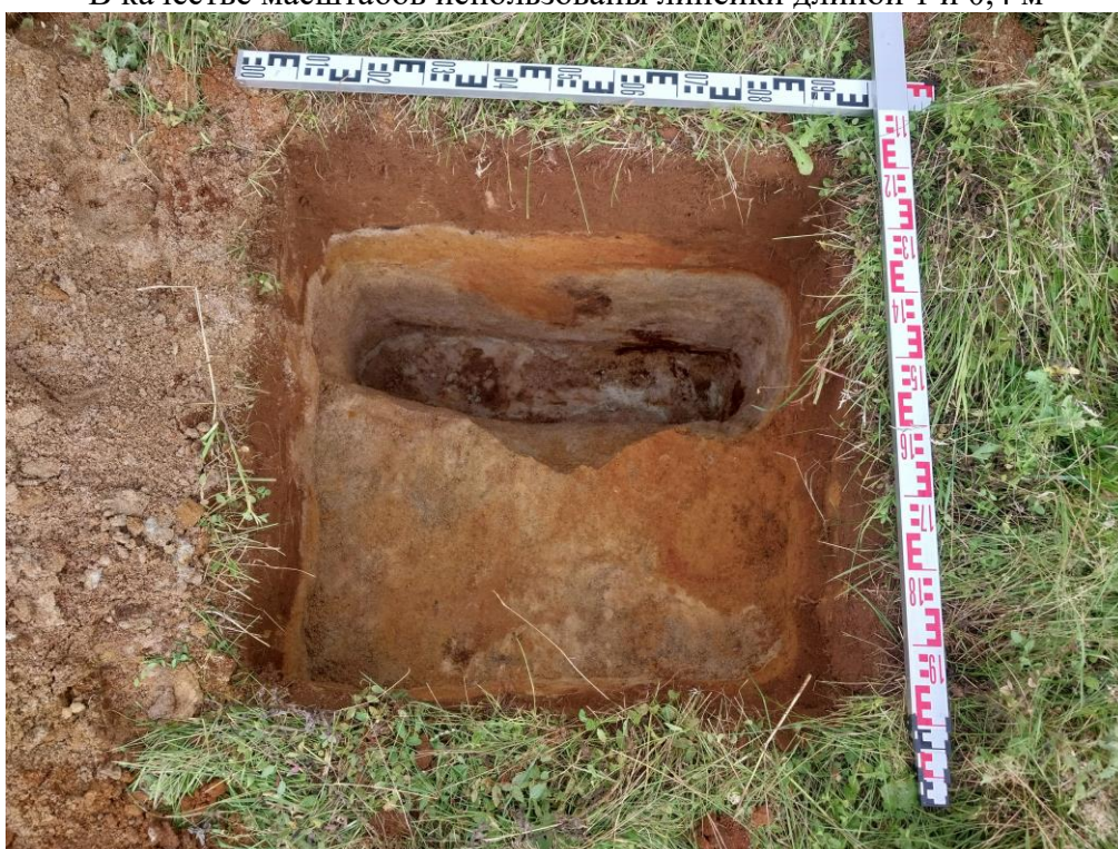
Рис. 13. г. Санкт-Петербург, Приморский район Участок обследования с кадастровым номером 78:34:0004281:74516 Шурф 1. Общий вид после проведения земляных работ Вид сверху с юга
