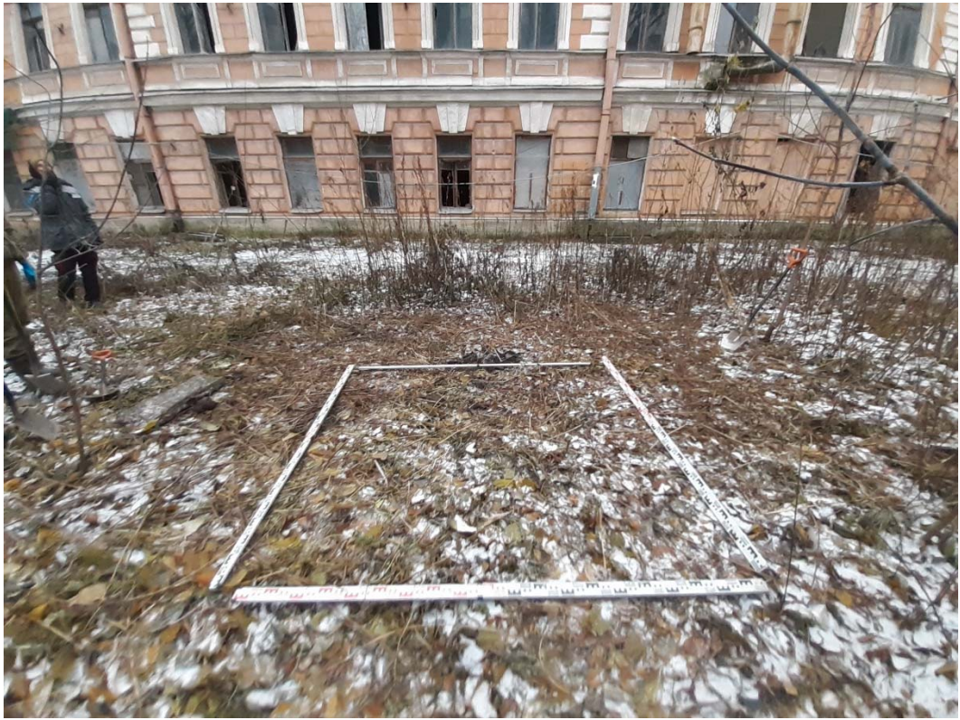
Рис. 39. Санкт-Петербург, Виленский пер. д. 19, Лит. А. Шурф 1. Фотофиксация дневной поверхности до начала работ. Вид на юг.
