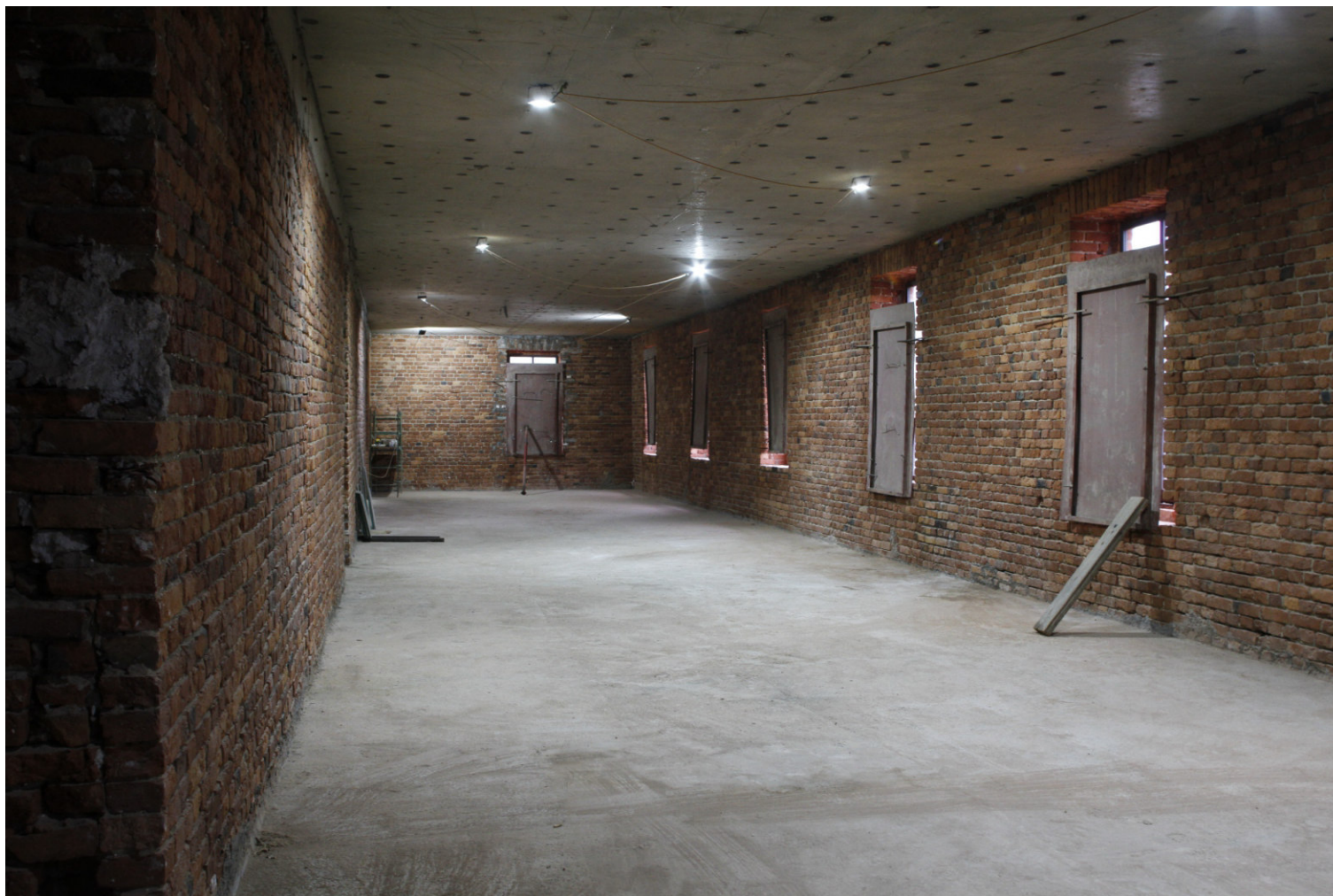
21. “Офицерский флигель (чайная”). г. Ломоносов, Владимирская ул., дом 15, лит.А. 2-й этаж. Фрагмент помещения кв. № 5. Фото:30.10.2023.
