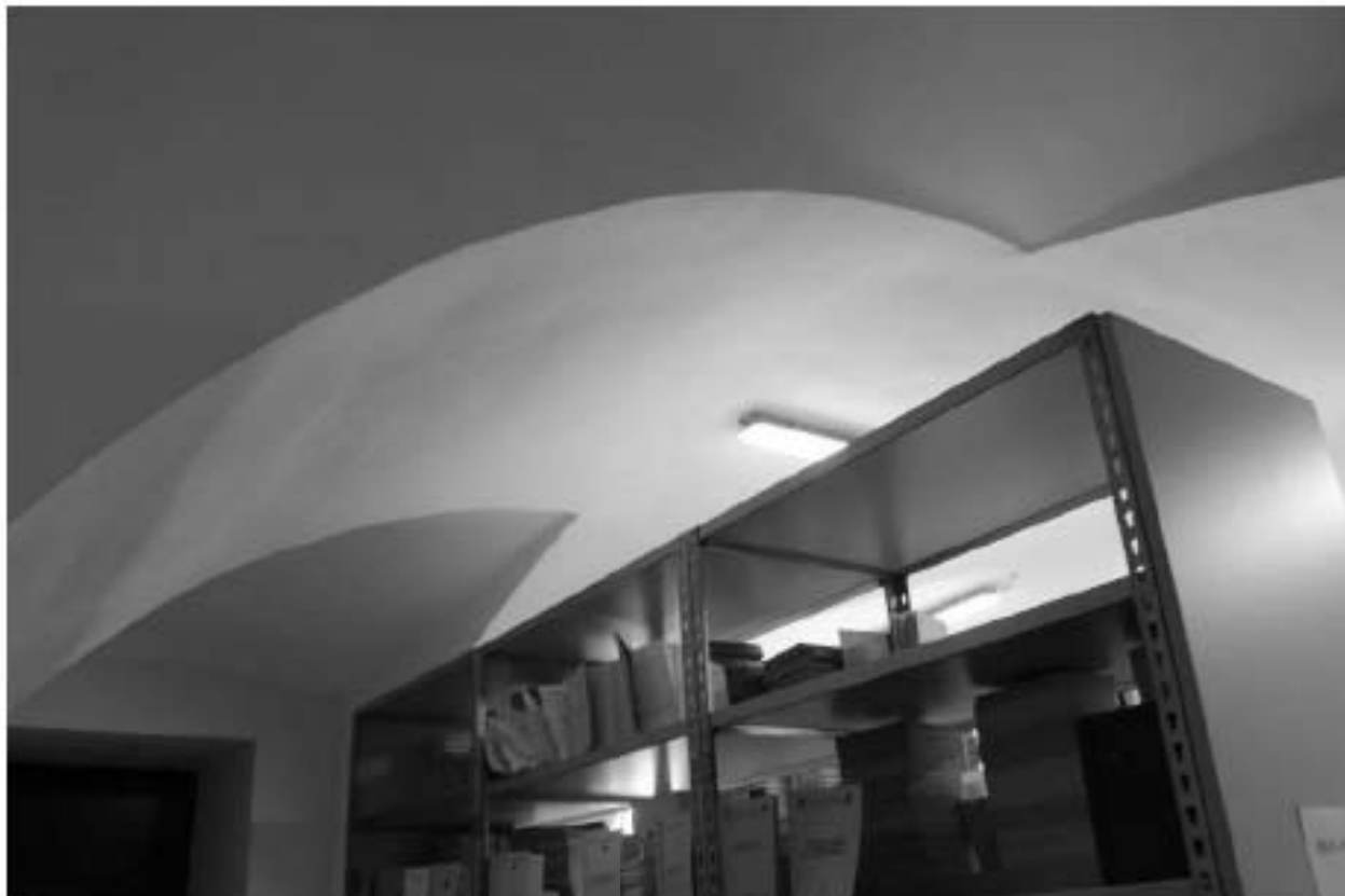
Фото 165. Выявленный объект культурного наследия «Главный корпус с 1-м солдатским корпусом, офицерским флигелем и Михайловское артиллерийское училище». Внутренние помещения 1-го этажа. Фото 03.05.2023 г.
