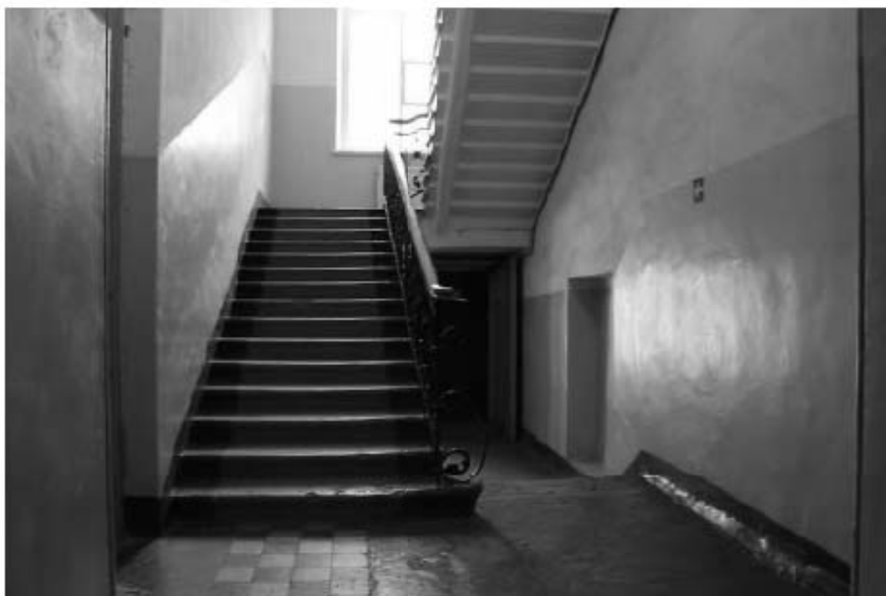
Фото 174. Выявленный объект культурного наследия «Корпус квартир офицеров (угловой)» (объект культурного наследия регионального значения «Академия Михайловская артиллерийская, где преподавали ученые Ленц Э.Х., Остроградский М.В., Петрушевский В.Ф.»). 10ЛК. Фото 03.05.2023 г.
