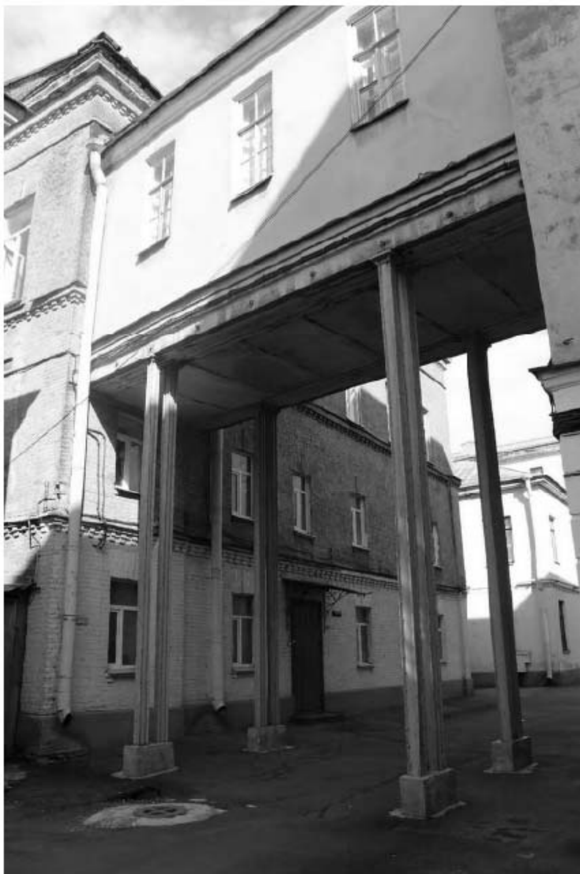
Фото 33. Вид на надземный переход между выявленным объектом культурного наследия «Баня» и южным корпусом выявленного объекта культурного наследия «Главный корпус с 1-м солдатским корпусом, офицерским флигелем и Михайловское артиллерийское училище». Фото 03.05.2023 г.
