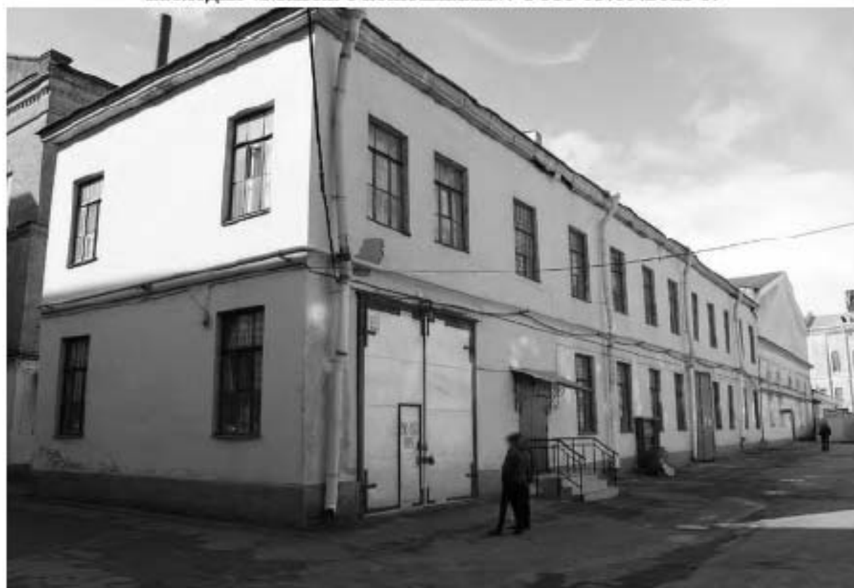
Фото 44. Вид на юго-восточное крыло выявленного объекта культурного наследия «Манеж с конюшнями». Фото 03.05.2023 г.
