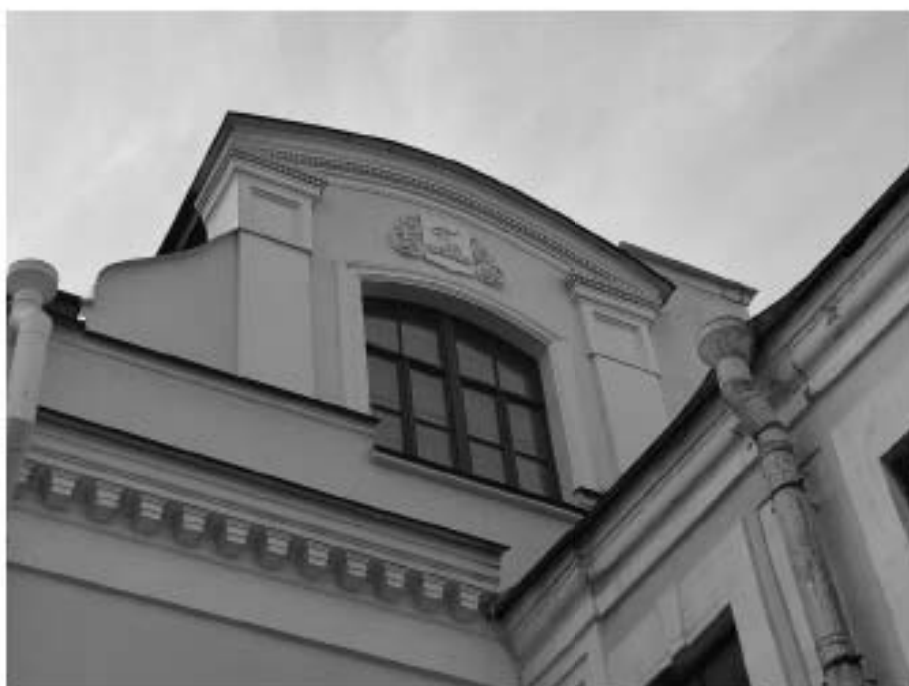
4. «Дом Боткина М.П.», ул. 18-я линия В.О., д.1, лит. А. Северо-восточный фасад. Фрагмент. Фото 22.06.2023г.
