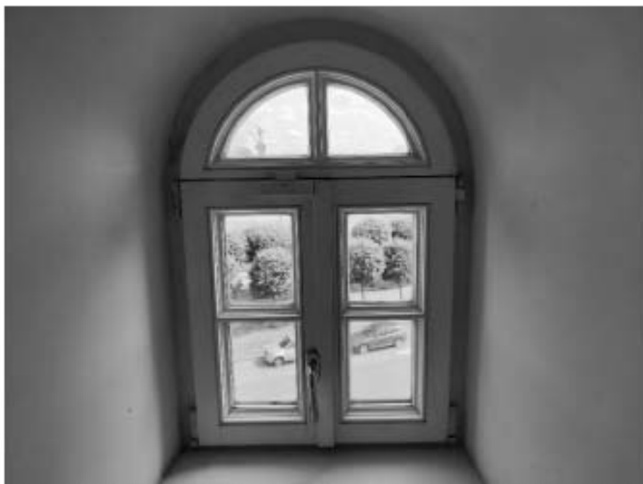
15. «Дом Боткина М.П.», ул. 18-я линия В.О., д.1, лит. А. Третий этаж. Помещение в осях 8-А. Оконное заполнение. Общий вид. Фото 22.06.2023г.
