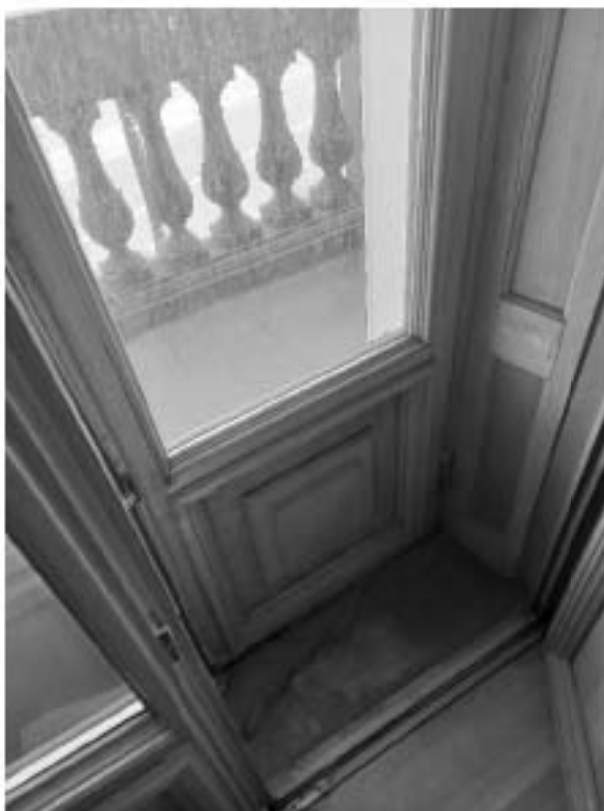
23. «Дом Боткина М.П.», ул. 18-я линия В.О., д.1, лит. А. Помещение второго этажа. Дверное заполнение балкона. Фрагмент. Фото 22.06.2023г. (фотография представлена заявителем).
