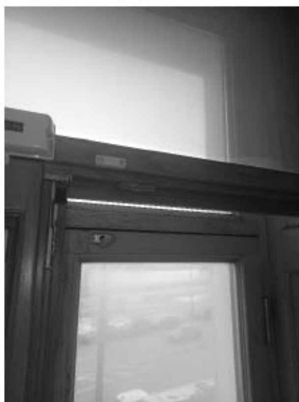
22. «Дом Боткина М.П.», ул. 18-я линия В.О., д.1, лит. А. Помещение второго этажа. Дверное заполнение балкона. Фрагмент. Фото 22.06.2023г. (фотография представлена заявителем).
