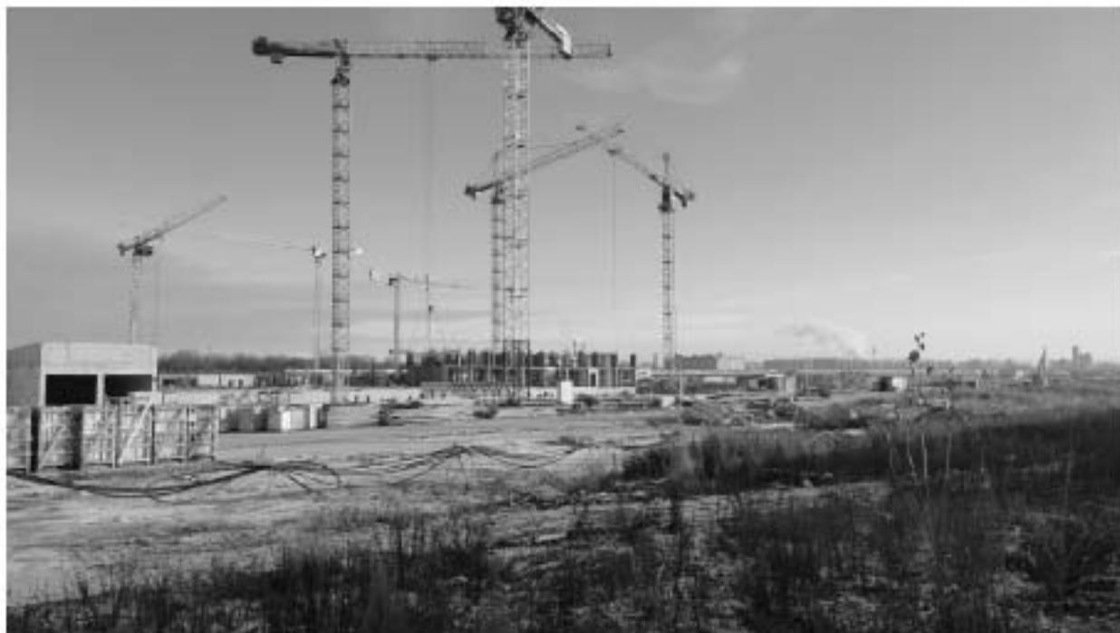
Точка фотофиксации 6. Общий вид центральной части территории обследования с СЗ. Строительная площадка жилого комплекса «Витебский парк».
