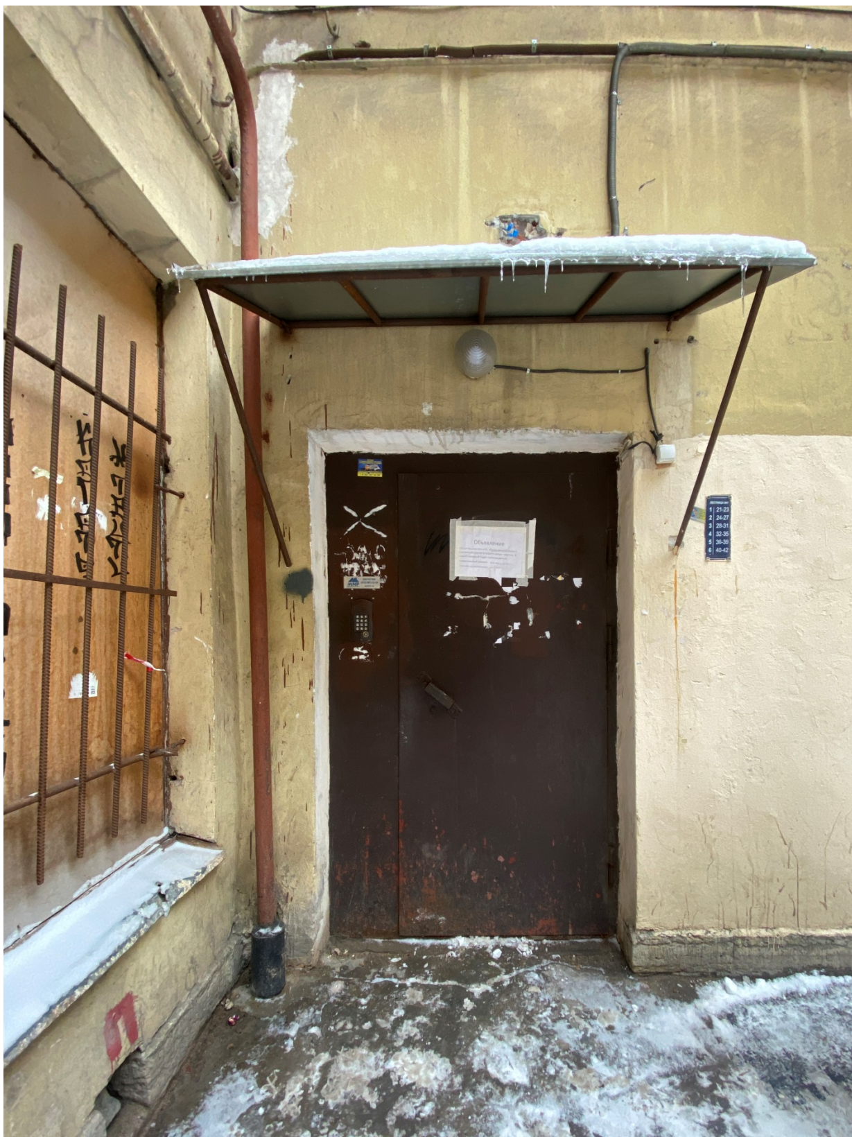
Фото 18. Вид на вход в парадную, ведущую в квартиру № 21, расположенную в части объекта культурного наследия
