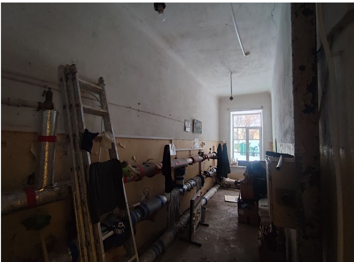
30. Объект культурного наследия регионального значения «Мужская гимназия с садом и оградой», расположенный по адресу: Санкт-Петербург, город Петергоф, Санкт-Петербургский проспект, дом 43, литера А. Общий вид пом. 1-Н (21) в уровне 1-го этажа.
