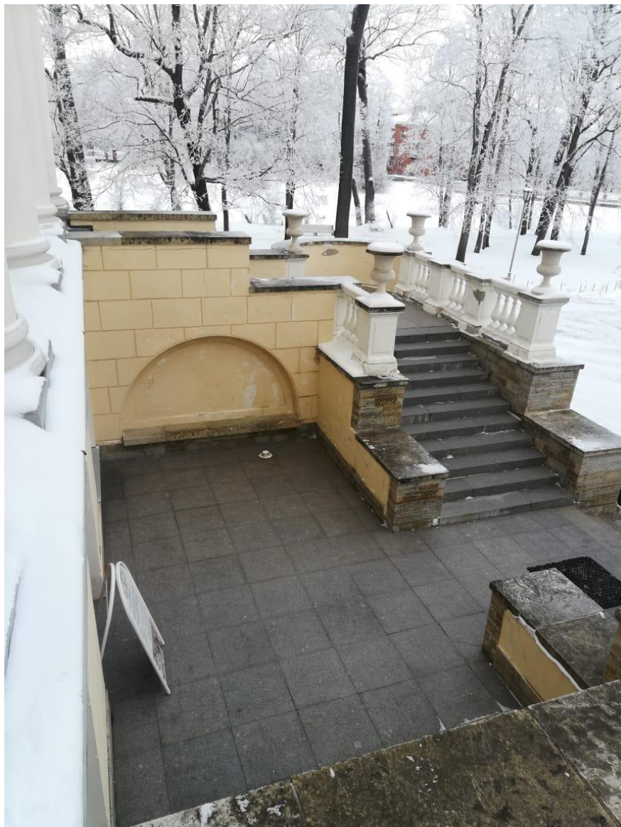
4. Объект культурного наследия федерального значения «Дом главный» по адресу: Санкт-Петербург, город Пушкин, Садовая улица, дом 22, литера А (Санкт-Петербург, г. Пушкин, Садовая ул., д. 22), входящий в состав объекта культурного наследия федерального значения «Дача Кочубей М.В. (Запасный дворец, Владимирский дворец)» (согласно постановлению Правительства РФ от 10.07.2001 № 527: г. Пушкин, Садовая ул., 22, Софийский бульв., 2, 4, 6, 8, 10). Восточный фасад. Двухмаршевая распашная фигурная в плане лестница с террасами и промежуточными площадками. Фрагмент.
