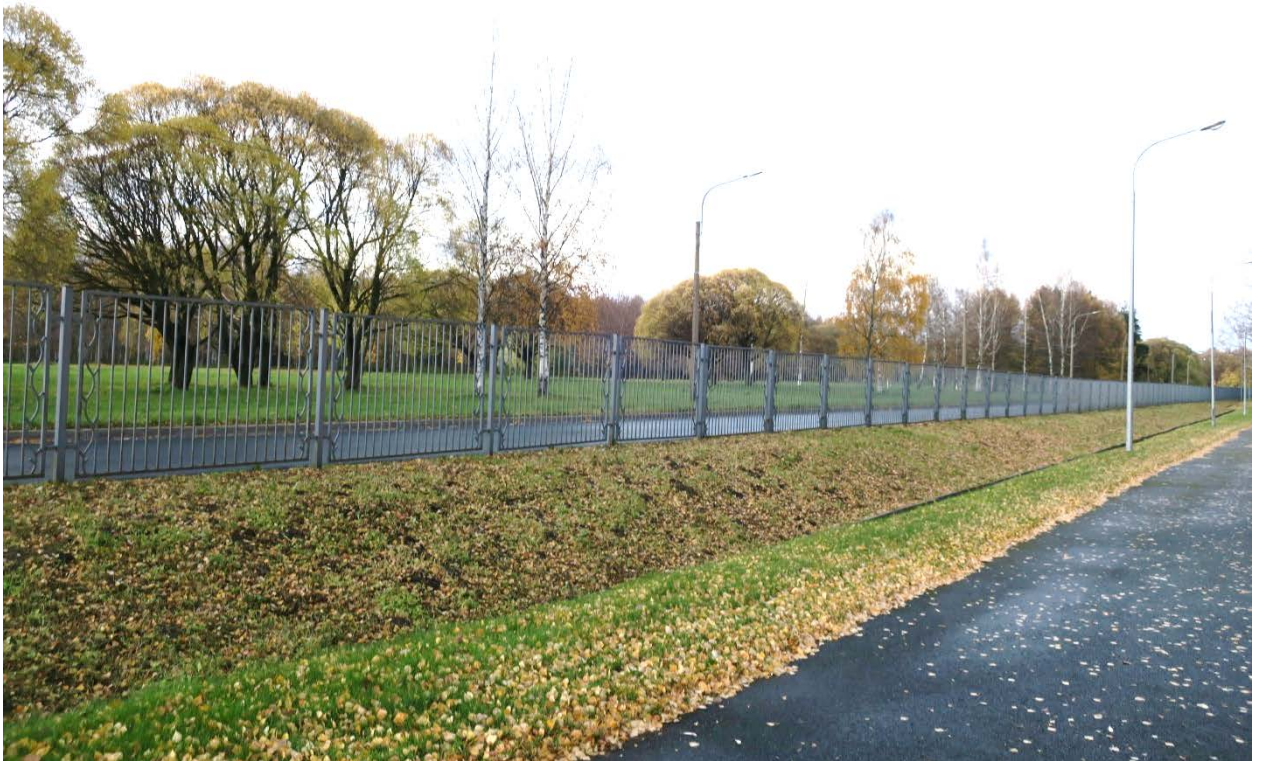
14. Западная часть ограды объекта культурного наследия федерального значения «Кладбище Пискаревское», расположенного по адресу: г. Санкт-Петербург, пр. Непокоренных, д. 72 литера А. 15.10.2021
