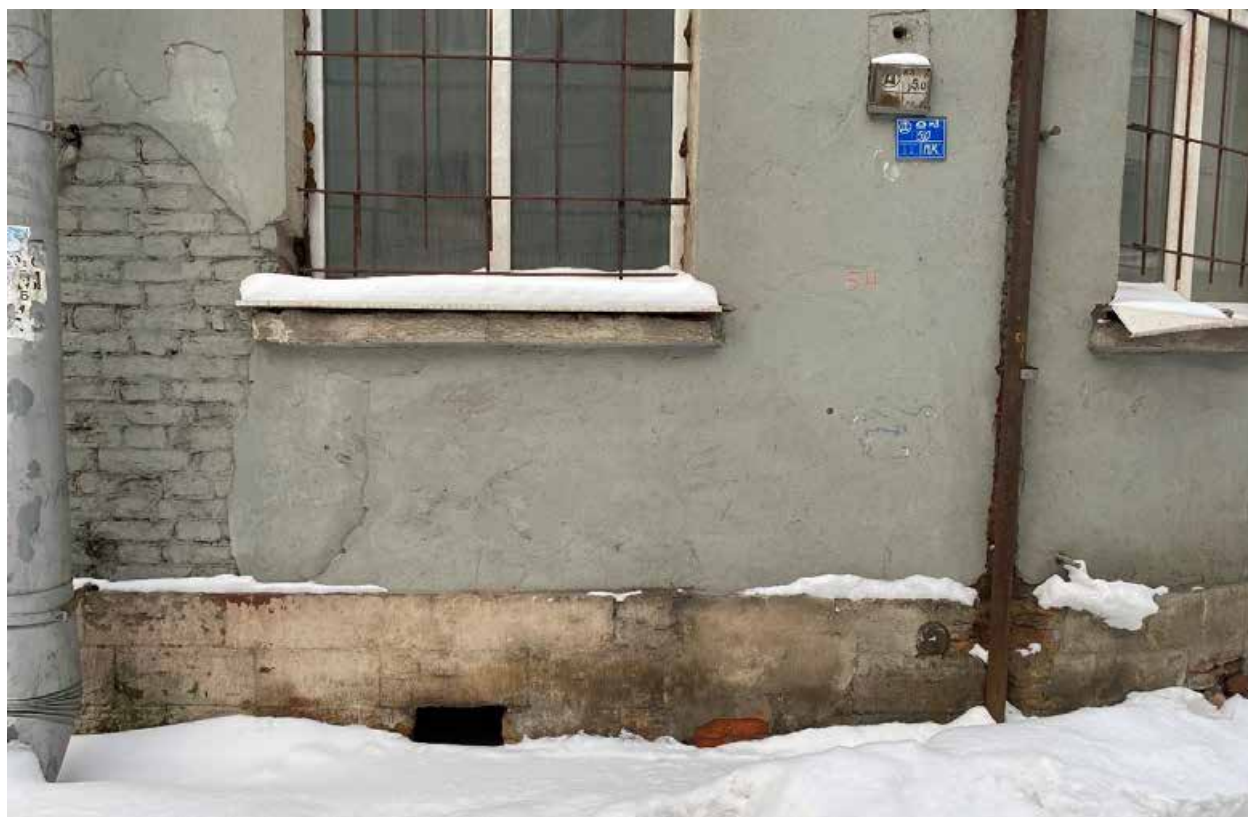
Фото 8. Фрагмент лицевого фасада по оси «1'» на Кожевенной улице. Сохранившееся подвальное окно в цокольной части.
