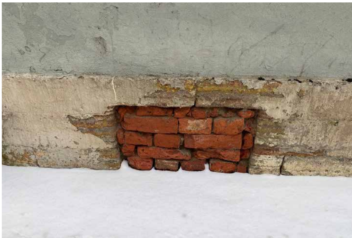
Фото 7. Фрагмент лицевого фасада возле оси «7» по Масляному каналу. Заложенное подвальное окно в цокольной части.
