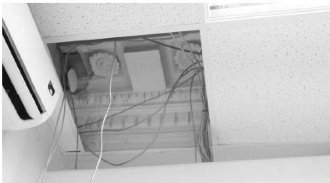
58. «Дом Н.Я. и Ф.Я. Колбозыло». Санкт-Петербург, Большой пр. П.С., 16-18; Красного курсанта ул., д.1; Пионерская ул., д.6, литера А. Большой пр. П.С., 18. 2-й этаж. Помещение 6-Н. Фрагмент потолка. Фото: 21.03. 2023.
