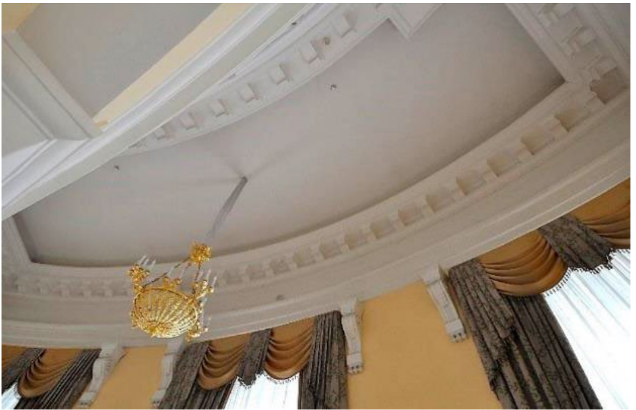
15. Помещение № 540 в уровне 2-го этажа объекта культурного наследия федерального значения «Дворец Таврический. Дворец», расположенного по адресу: г. Санкт-Петербург, ул. Шпалерная, д. 47, лит. А. 01.11.2023
