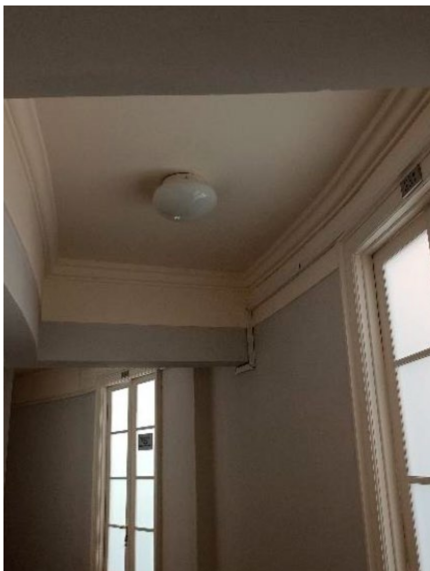
13. Помещение № 539 в уровне 2-го этажа объекта культурного наследия федерального значения «Дворец Таврический. Дворец», расположенного по адресу: г. Санкт-Петербург, ул. Шпалерная, д. 47, лит. А. 01.11.2023
