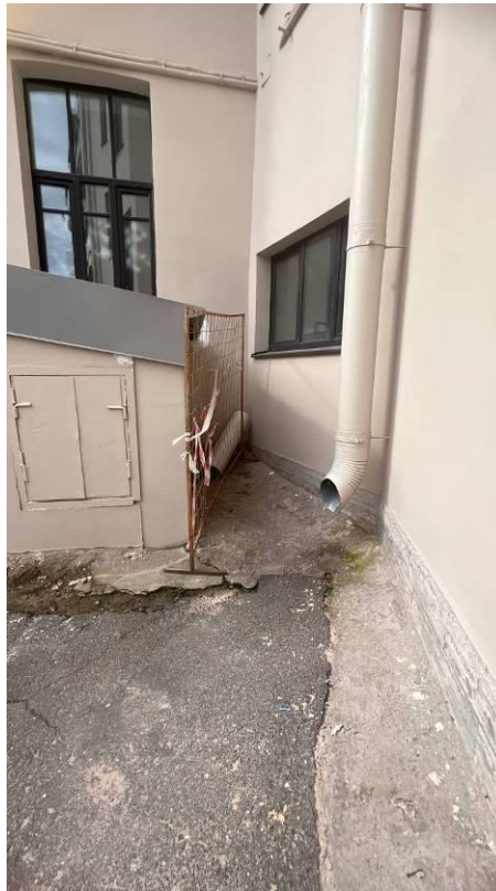
Фото 7. Вид на дворовые фасады объекта культурного наследия регионального значения «Здание приюта для детей-идиотов и эпилептиков Братства во имя Царицы Небесной с примыкающей часовней при домово́й церкви Божьей Матери Скорбящих Радости»
