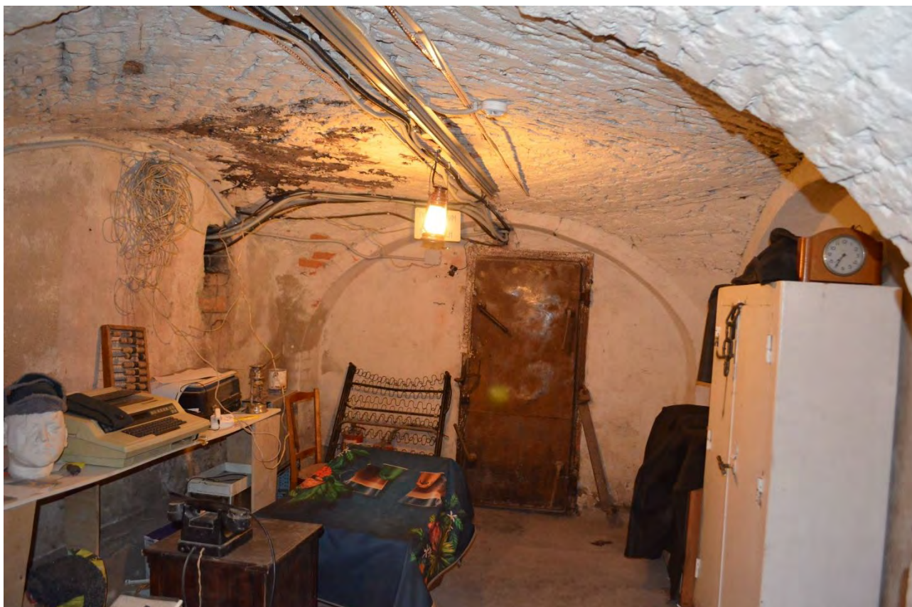
Фото 31. Объект культурного наследия федерального значения «Церковь лютеранская Воскресения Христова». Подвал. Помещение 2-Н (1). Фрагмент. Съёмка 31.10.2022 г.
