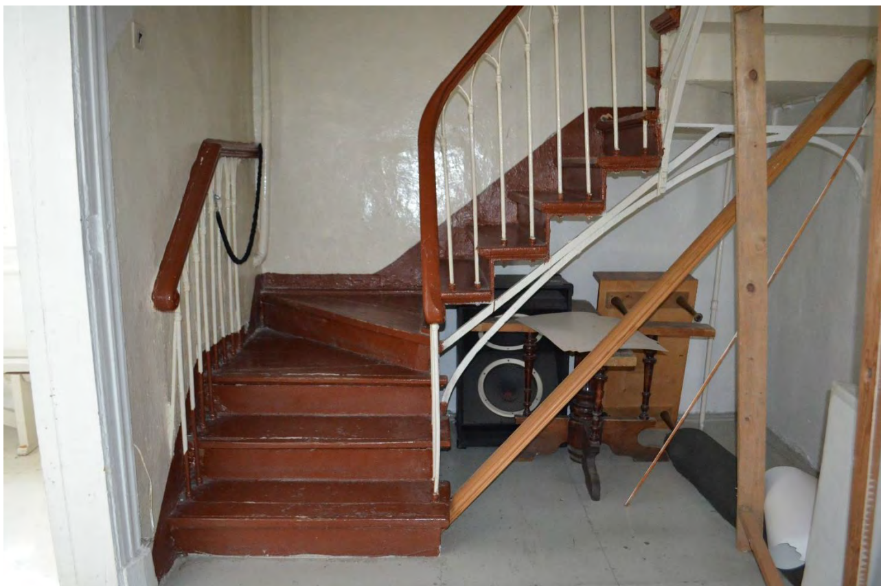
Фото 79. Объект культурного наследия федерального значения «Церковь лютеранская Воскресения Христова». Второй этаж. Помещение 1-Н (15). Лестница, ведущая на хоры. Фрагмент. Съёмка 31.10.2022 г.
