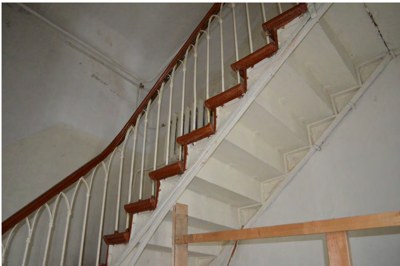
Фото 80. Объект культурного наследия федерального значения «Церковь лютеранская Воскресения Христова». Второй этаж. Помещение 1-Н (15). Лестница, ведущая на хоры. Фрагмент. Съёмка 31.10.2022 г.
