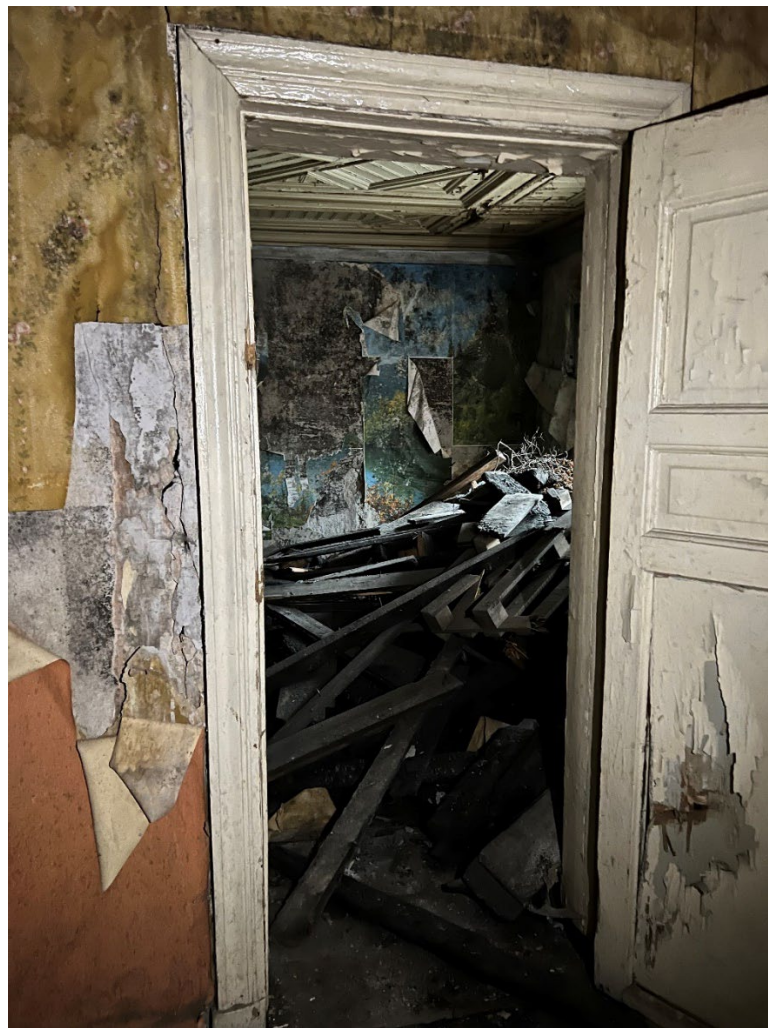
24. Помещение №7 (4-Н) в уровне 1-го этажа выявленного объекта культурного наследия «Жилой дом (деревянный)».
