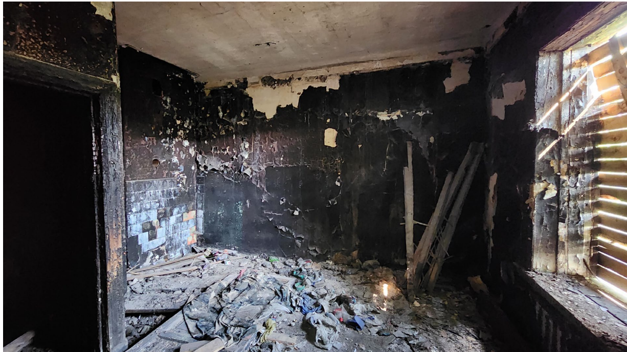
44. Помещение №8 (6-Н) в уровне 2-го этажа выявленного объекта культурного наследия «Жилой дом (деревянный)».
