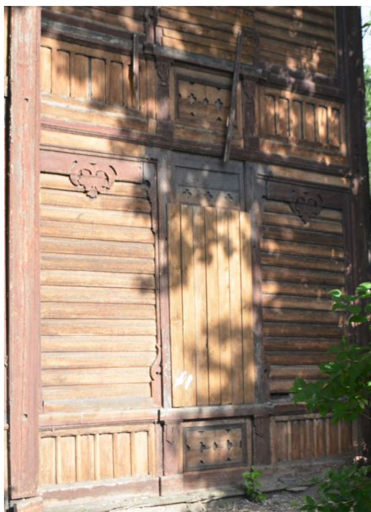
4. Выявленный объект культурного наследия «Жилой дом (деревянный)». Западный фасад. Сохранившиеся элементы резного декора фасада и оконного проема. Вид с запада.
