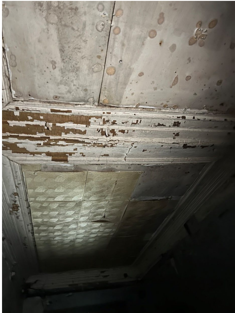
22. Потолок коридора (пом. 4 (4-Н) в уровне 1-го этажа выявленного объекта культурного наследия «Жилой дом (деревянный)».
