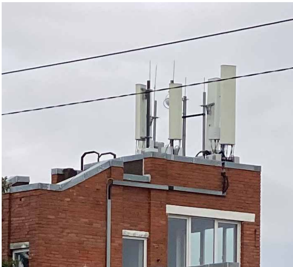
2. Вид на крышу здание по адресу: Санкт-Петербург, Южная дорога, д. 25, литера П.
