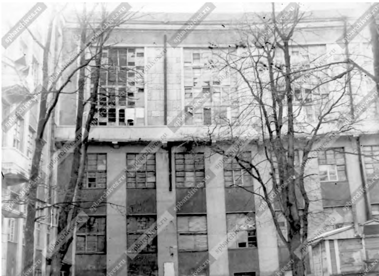
Илл. 35 Часть учебного корпуса Лесотехнической академии им. С.М. Кирова, поврежденного при обстреле Дата съемки: 1944 г. (Архив: ЦГАКФФД СПб, шифр: Вр 939)
