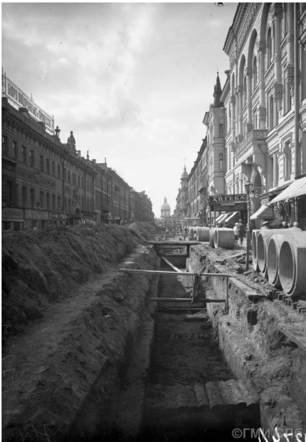
Илл. 60. Канализационные работы на улице Пестеля. Укладка труб в траншеи. 1924 г. (источник: госкаталог.рф № 13172401).
