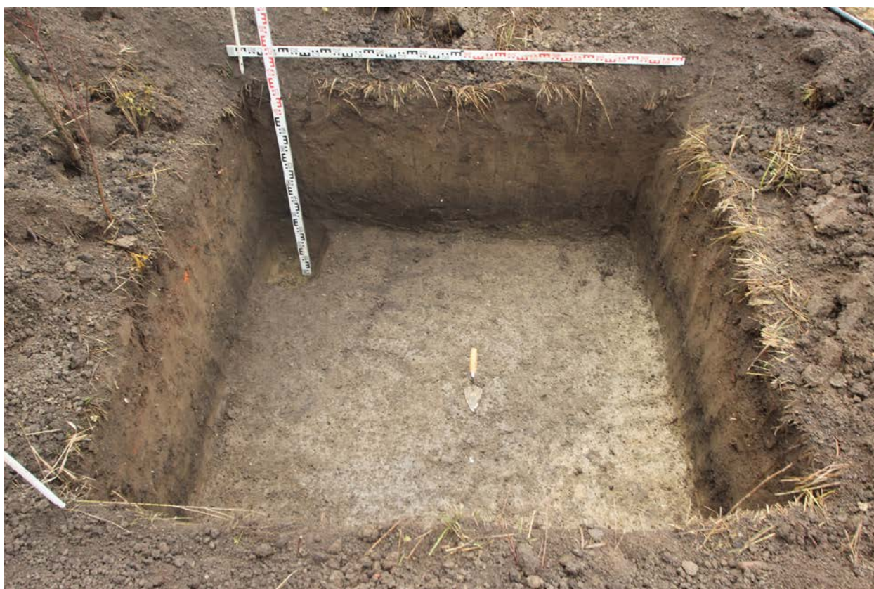
Рис. 31. Колпино-2023. Заречная улица, пешеходный мост. Шурф 1, фиксация по уровню окончания работ, вид на юг.
