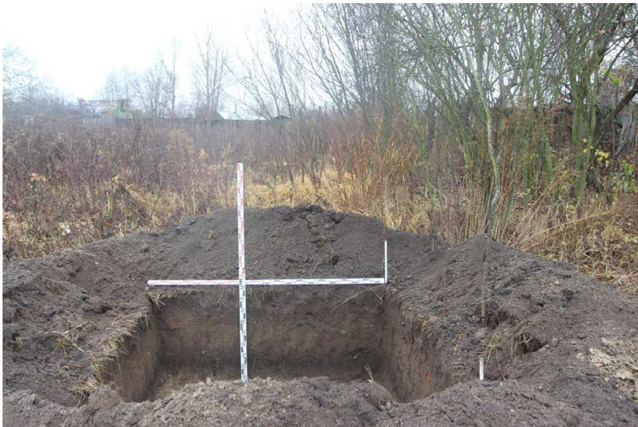
Рис. 26. Колпино-2023. Заречная улица, пешеходный мост. Шурф 1, фиксация по уровню окончания работ, вид на север.
