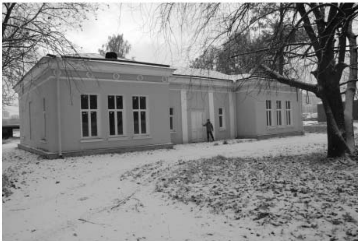
Рис. 29. Санкт-Петербург, ул. Академика Павлова, д. 11а (участок 1) и ул. Академика Павлова, д. 11 а, литера А. Общий вид на участок обследования и южный фасад Павильона водной станции с ЮЮЗ.
