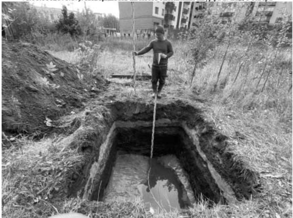
Рис. 71. СПб, Средний проспект В.О., дом 77, литера Ф (кадастровый номер: 78:06:0002076:17). Шурф 2. Фиксация дна шурфа по матерiku на уровне стояния грунтовых вод. Вид с севера
