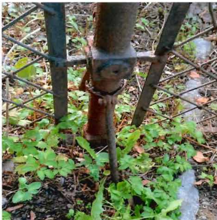
Фото 16: фрагмент объекта культурного наследия: фрагмент исторической чугуной ограды (волютообразный контрфорс с внутренней стороны ограды).
