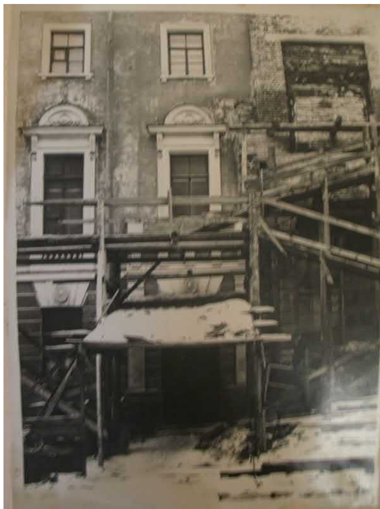
Илл. 24. Строительство репетиционных залов и гримборных на месте электростанции театра.1936 г. Фото из собрания театра.
