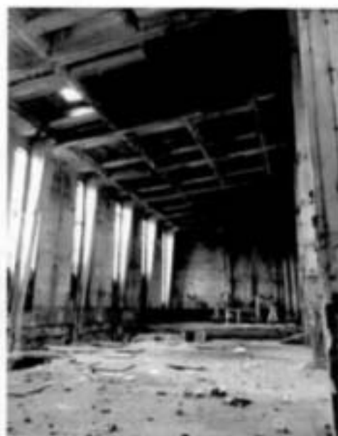
Фото 7. База, котельный зал.
