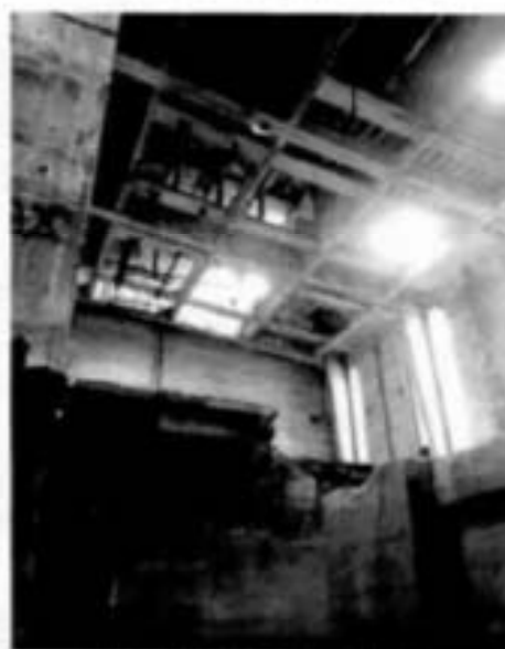
Фото 9. База, котельный зал.
