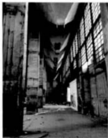
Фото 8. База, котельный зал.
