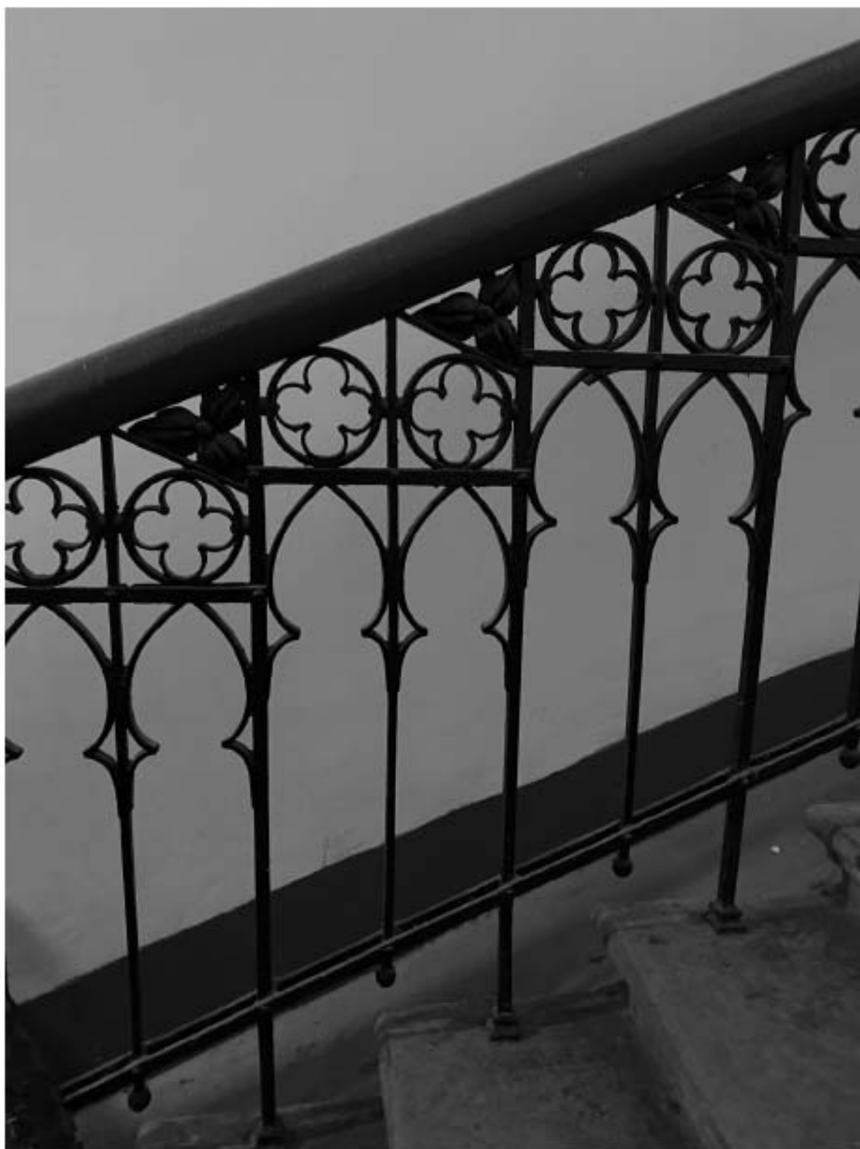
Фото 14. Вид на ограждение лестницы, ведущей в квартиру № 39, объекта культурного наследия.
