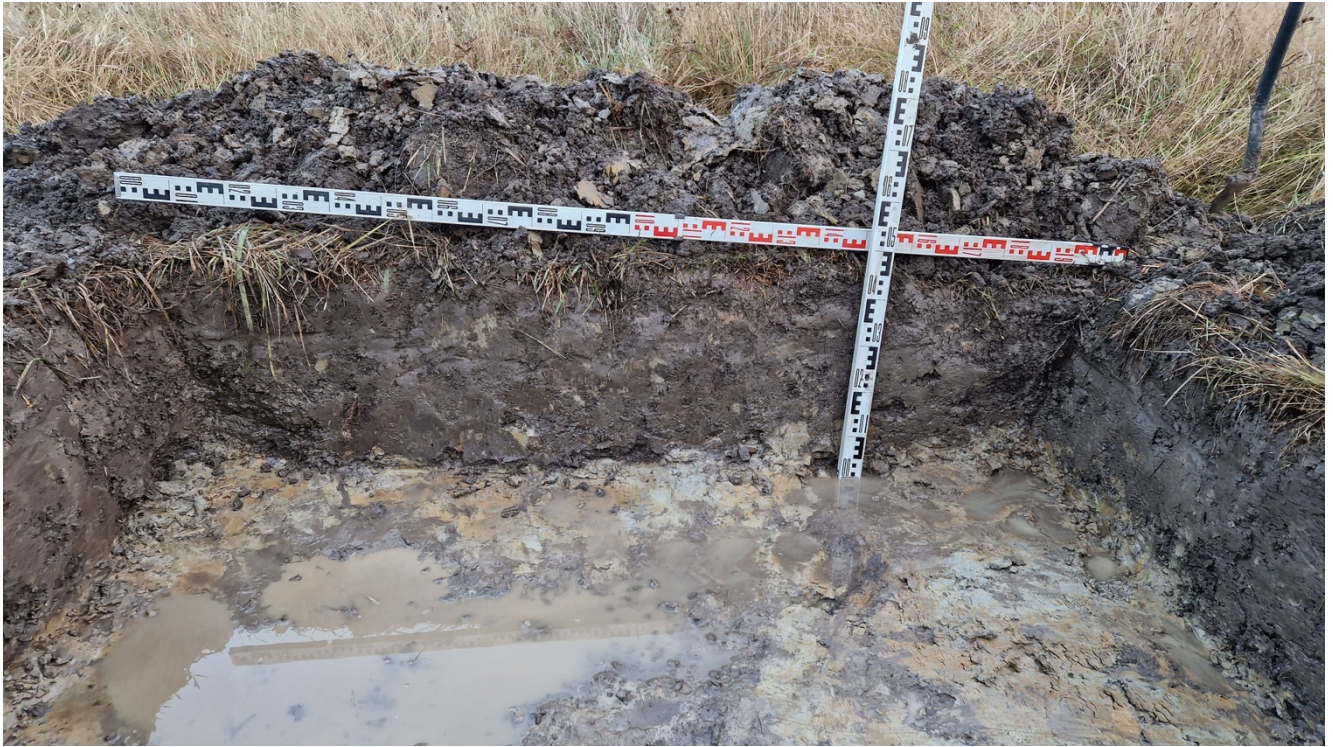
Рис.30. СПб, внутригородское муниципальное образование города федерального значения поселок Шушары, Колпинское шоссе (кадастровый номер: 78:42:0018326:375) Шурф №1. Фиксация восточной стенки.
