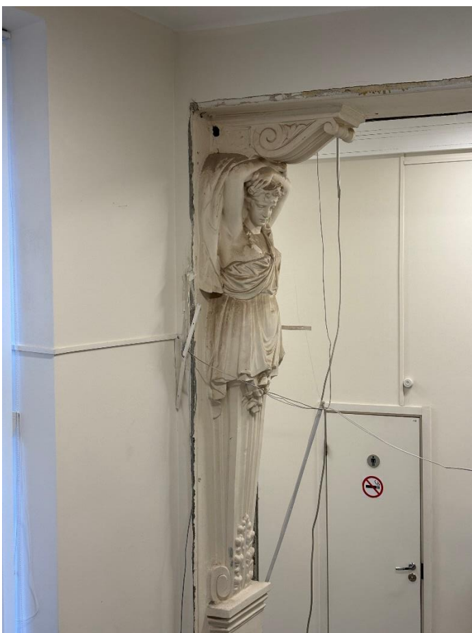
18. «Дом Волконской», Графский переулок, дом 2/48, литера А. Второй этаж. Помещение №106. Кариатида. Общий вид. Фото 01.12.2023г.
