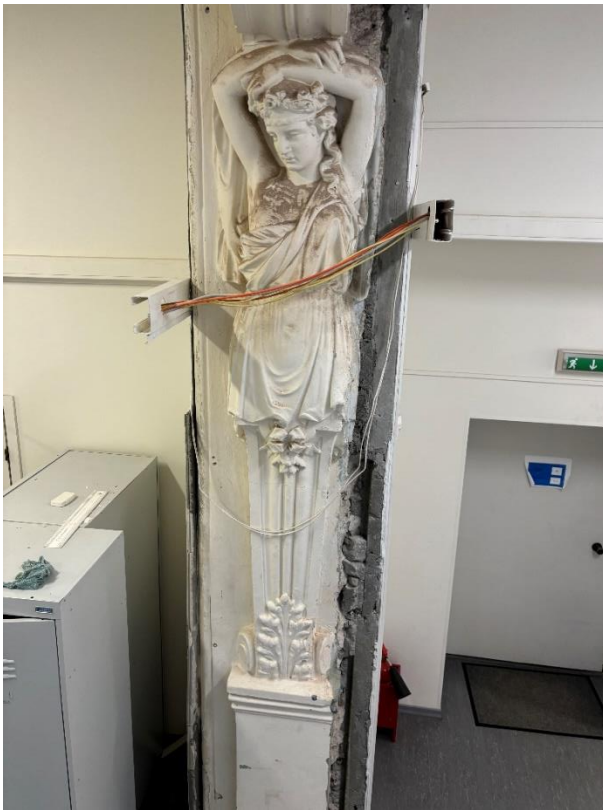
10. «Дом Волконской», Графский переулок, дом 2/48, литера А. Второй этаж. Помещение №106. Кариатида. Общий вид. Фото 01.12.2023г.
