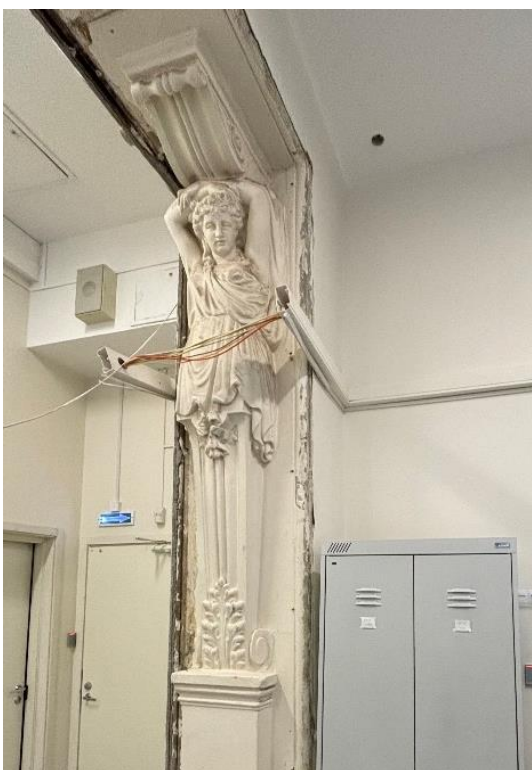
6. «Дом Волконской», Графский переулок, дом 2/48, литера А. Второй этаж. Помещение №106. Кариатида. Общий вид. Фото 01.12.2023г.
