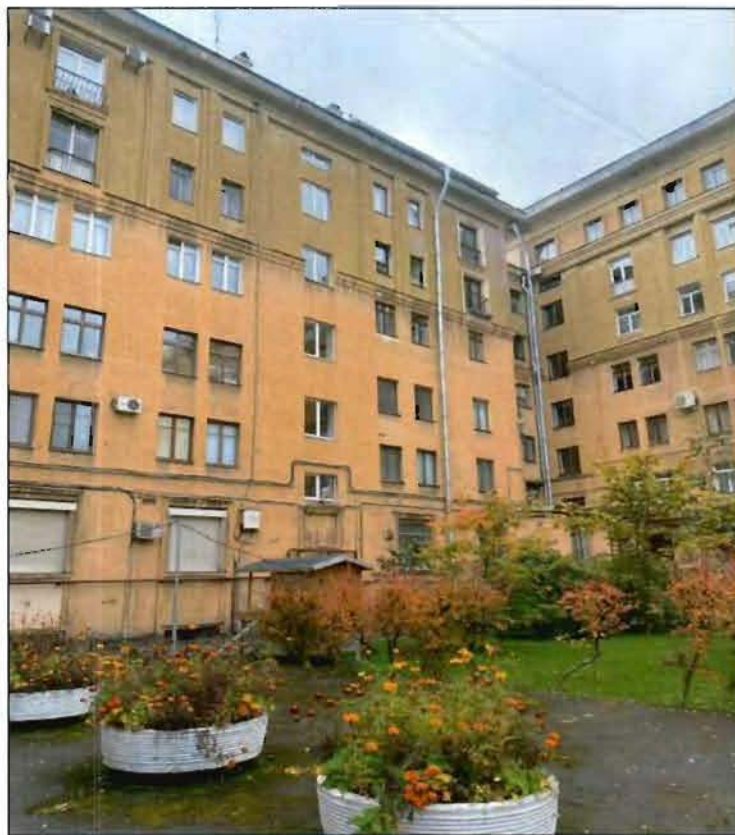
6. Фрагмент западной части северного и южной части западных фасадов объекта культурного наследия.
