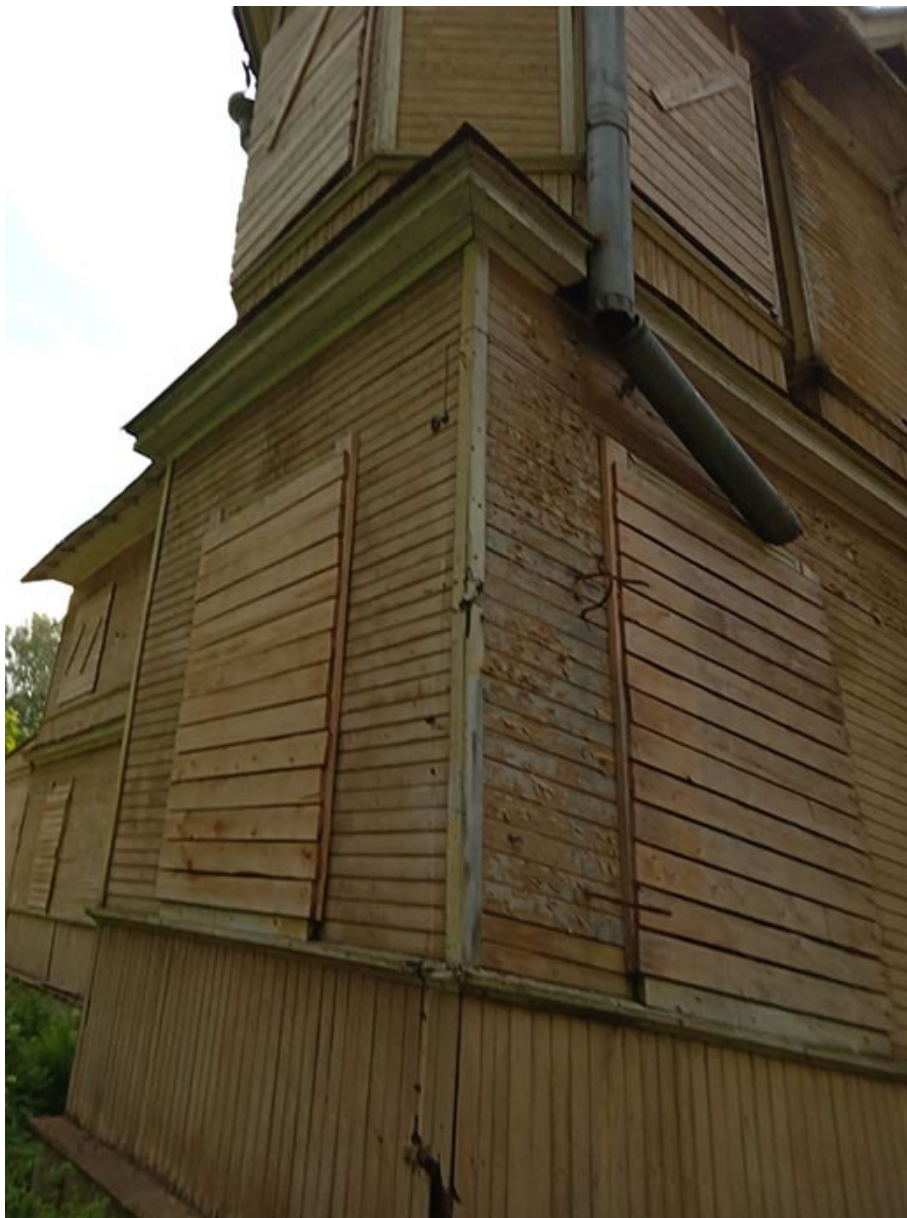
Фото 16. Выявленный объект культурного наследия «Дом купца Елисеева (ресторан) (деревянный)» по адресу: Санкт-Петербург, г. Зеленогорск Приморское шоссе, д. 520 литера Ц.
