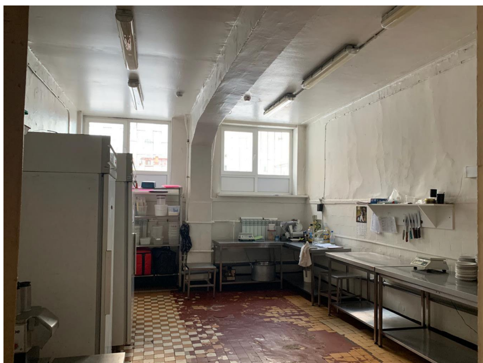
25. Выявленный объект культурного наследия «Здание школы» по адресу: Санкт-Петербург, Балтийская ул., д. 35, лит. А (Балтийская ул., 35). Столовая. Холодный цех. Общий вид.
