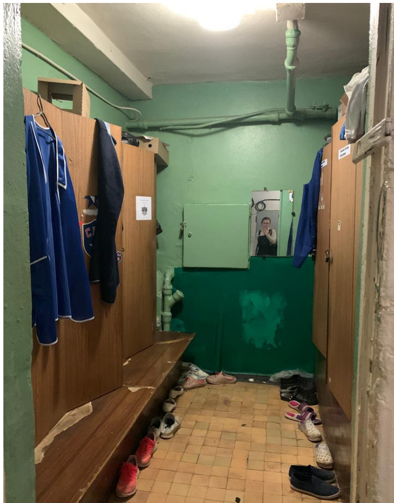
35. Выявленный объект культурного наследия «Здание школы» по адресу: Санкт-Петербург, Балтийская ул., д. 35, лит. А (Балтийская ул., 35). Столовая. Помещение раздевалки. Общий вид.
