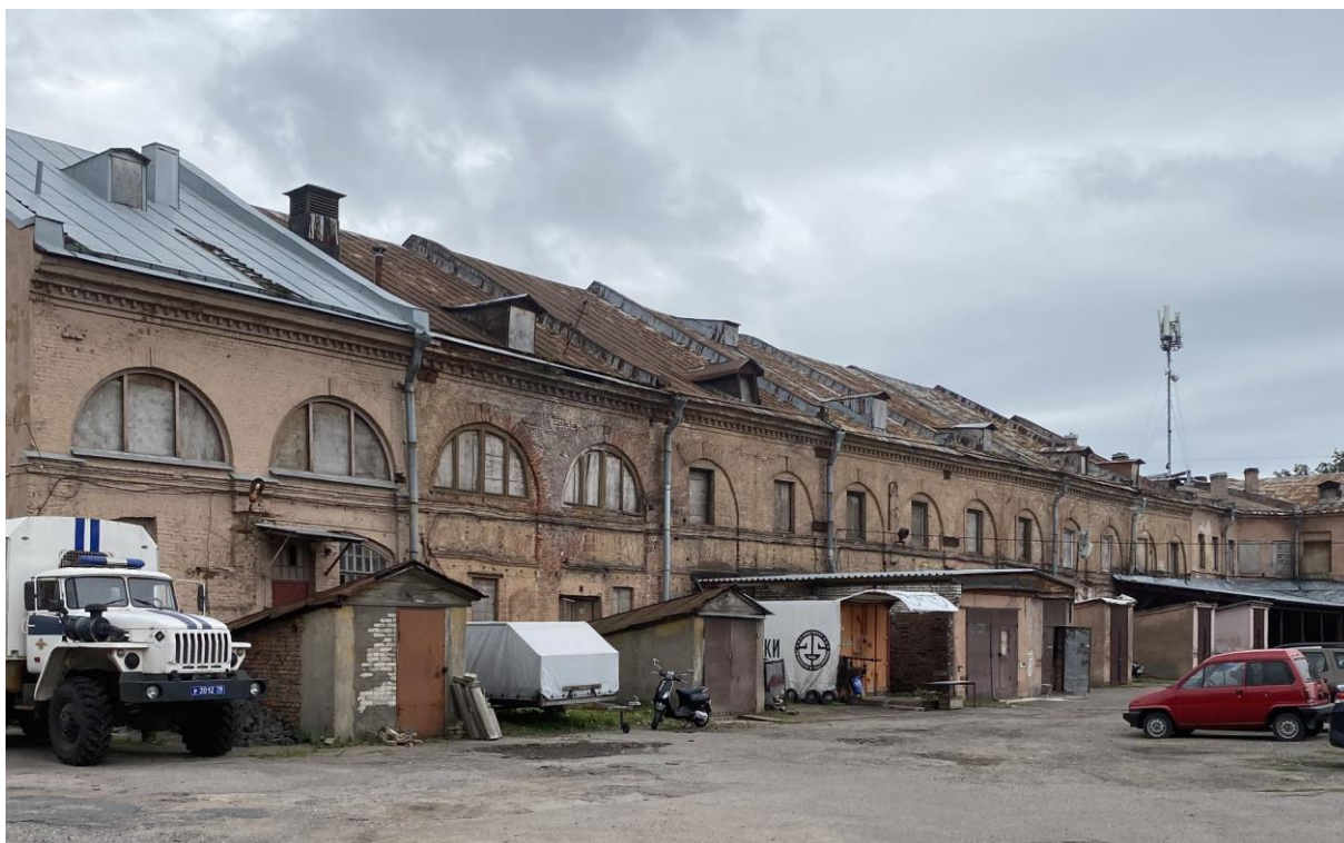
Фото 5. Дворовый фасад восточного корпуса. Многочисленные поздние пристройки входов в подвал.
