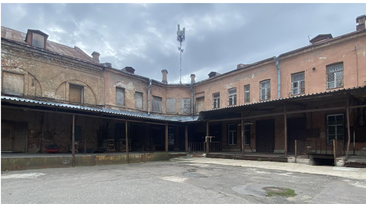
Фото 8. Фрагмент дворовых фасадов восточного и западного корпусов. Граница архитектурно-художественного решения фасадов. Поздние навесы.
