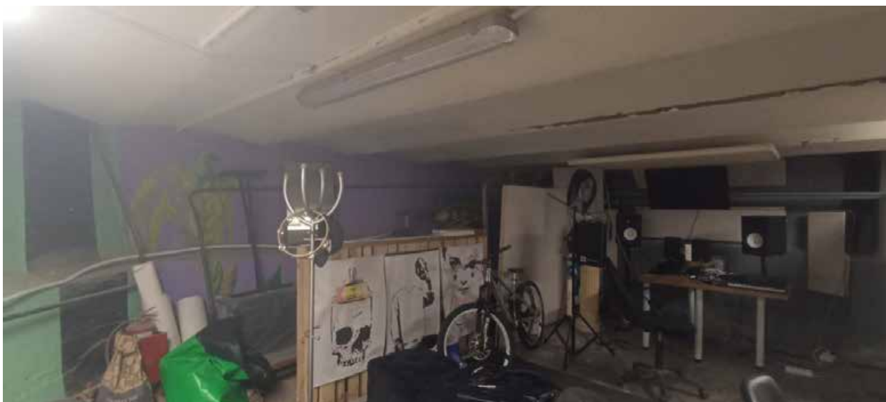
Фото 5. Интерьер подвального этажа объекта культурного наследия регионального значения «Здание приюта для детей-идиотов и эпилептиков Братства во имя Царицы Небесной с примыкающей часовней при домово́й церкви Божьей Матери Скорбящих Радости»
