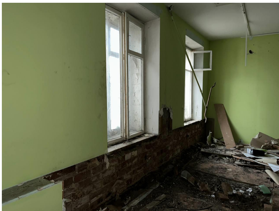
Фото №18. Разрушение отделочного покрытия в помещении 1-го этажа.
