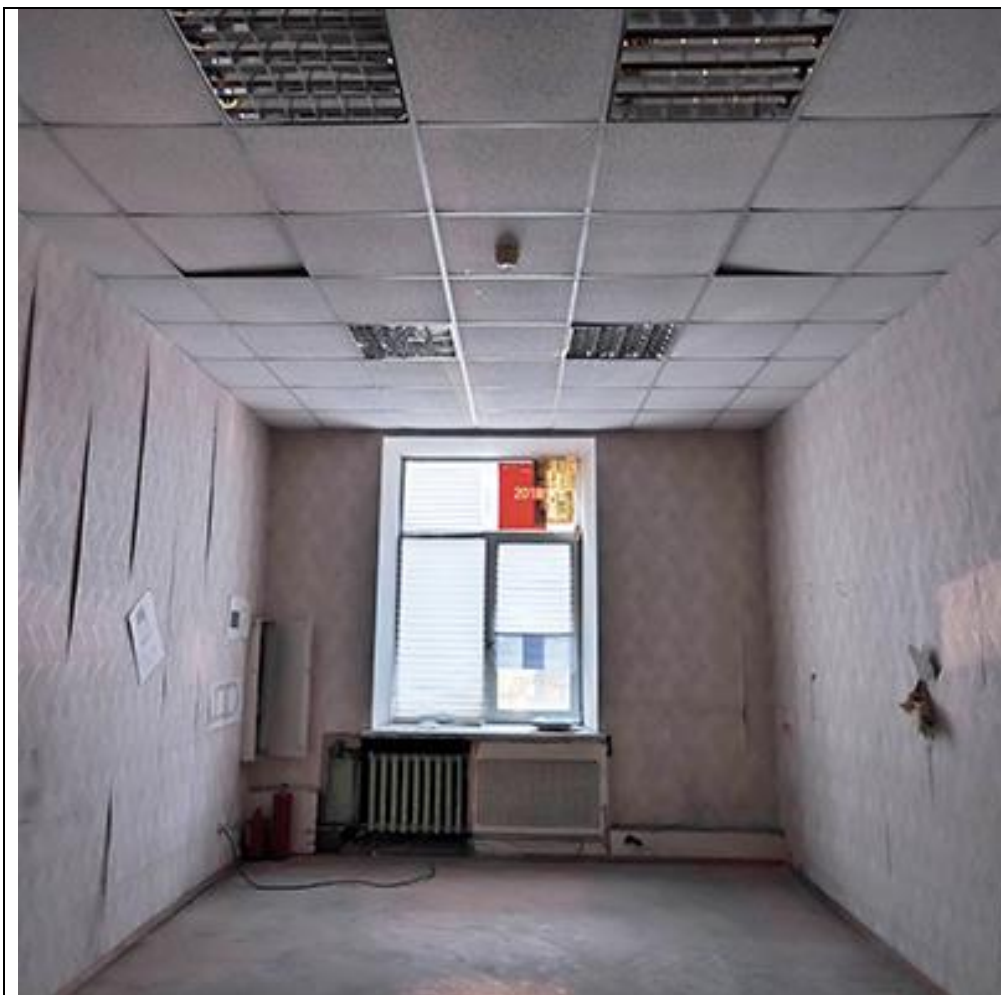
Фото №13. Вид на потолок. Пом. 32
