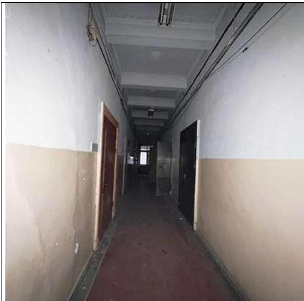
Фото №7. Вид на потолок коридора. Пом. 10
