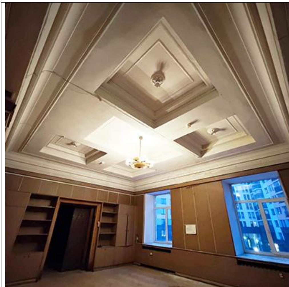
Фото №9. Вид на потолок. Пом. 46
