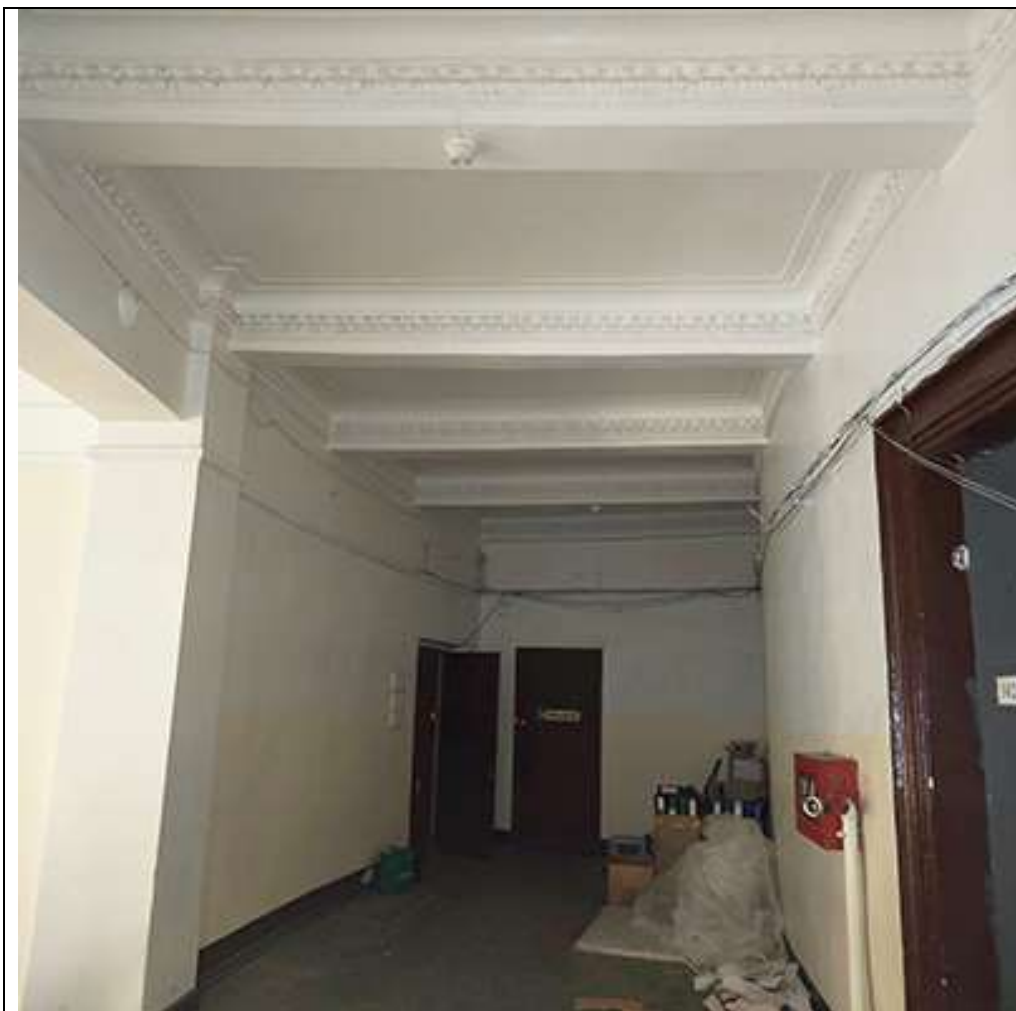
Фото №1. Вид на потолок холла главной лестницы. Пом. 17
