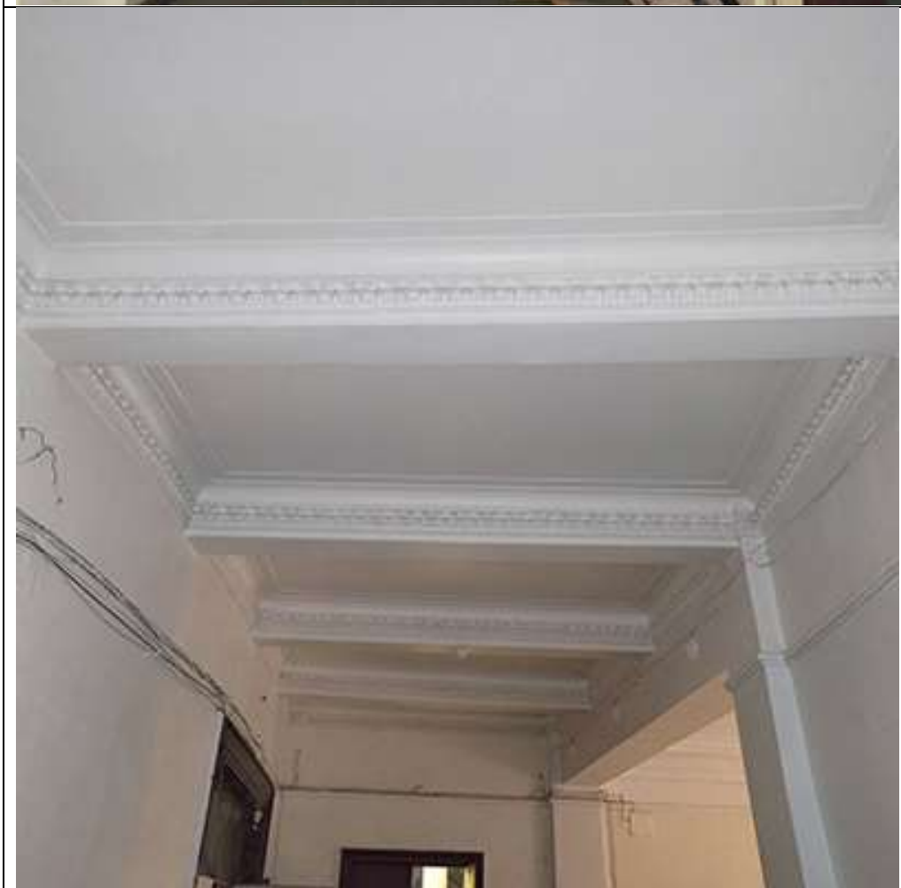
Фото №2. Вид на потолок холла главной лестницы. Пом. 17
