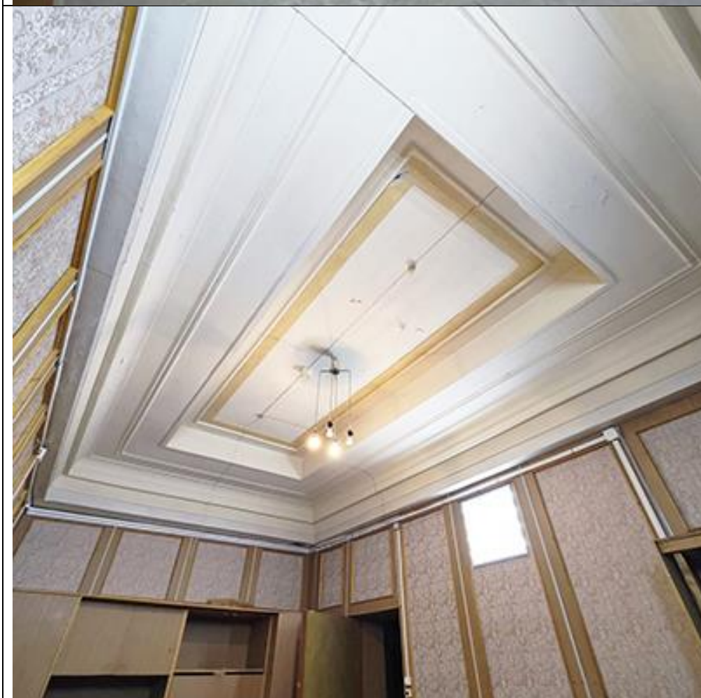
Фото №8. Вид на потолок. Пом. 47
