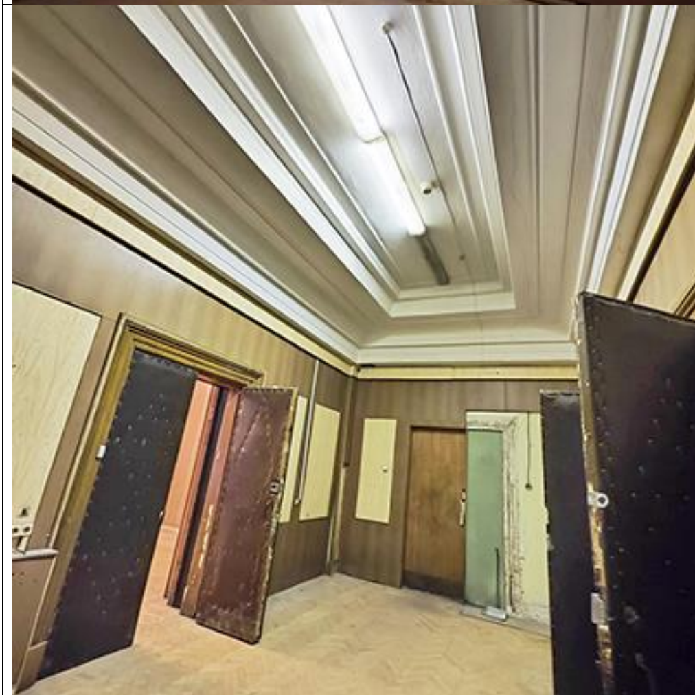
Фото №10. Вид на потолок. Пом. 45
