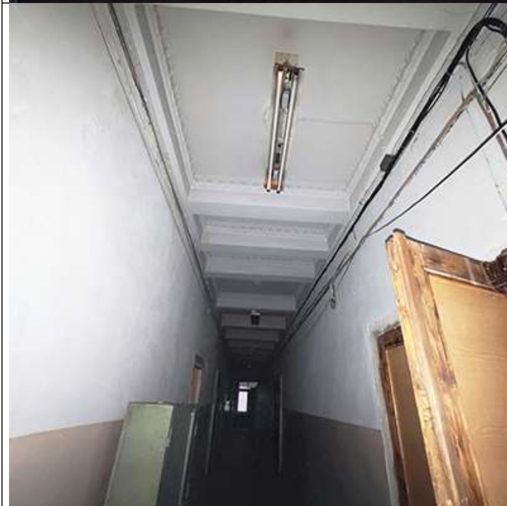
Фото №6. Вид на потолок коридора. Пом. 10
