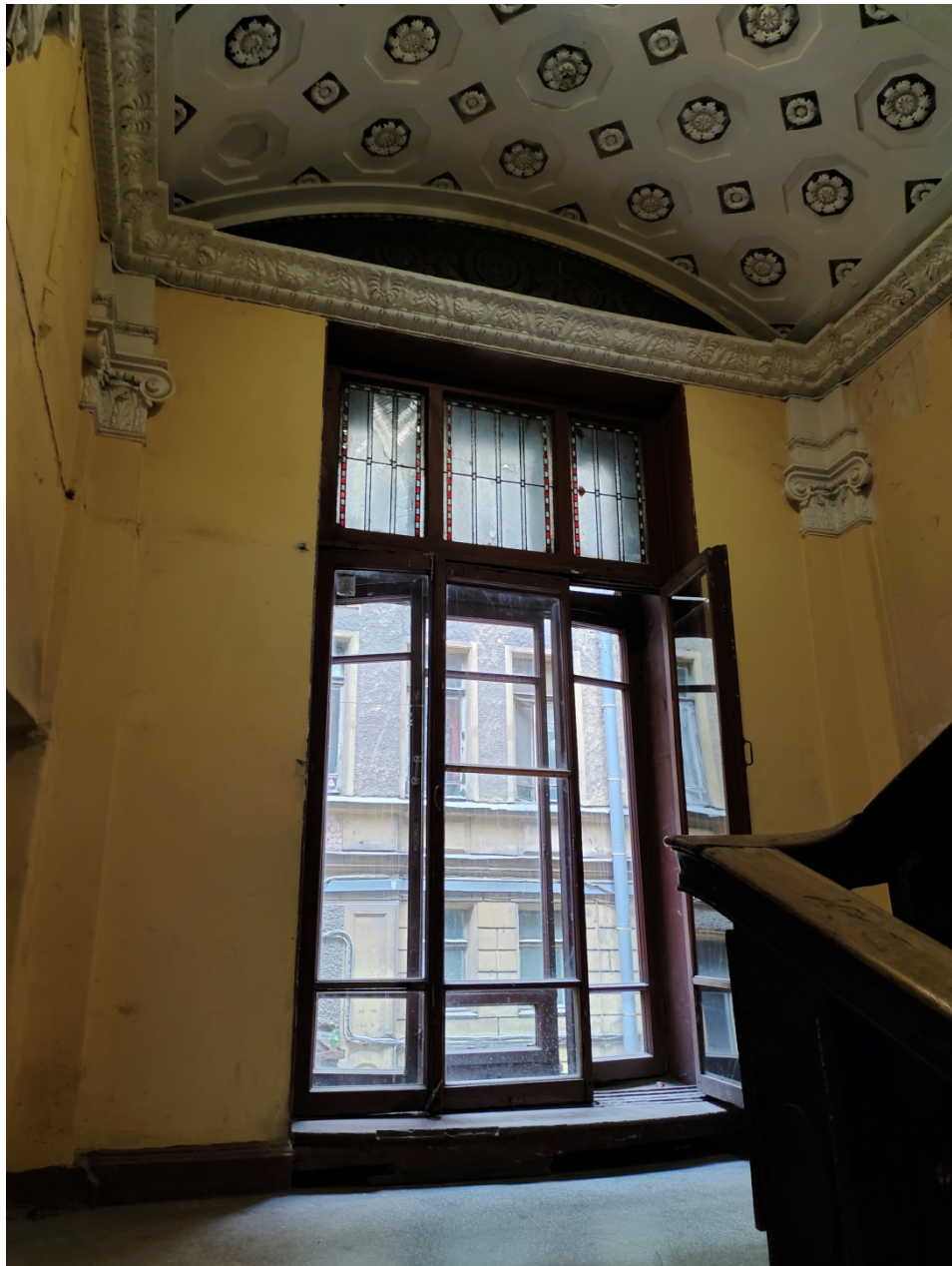
7. Объект культурного наследия регионального значения «Доходный дом А.П. Мещерского» (г. Санкт-Петербург, Кирочная ул., д. 22, лит. А). Парадная лестница.
