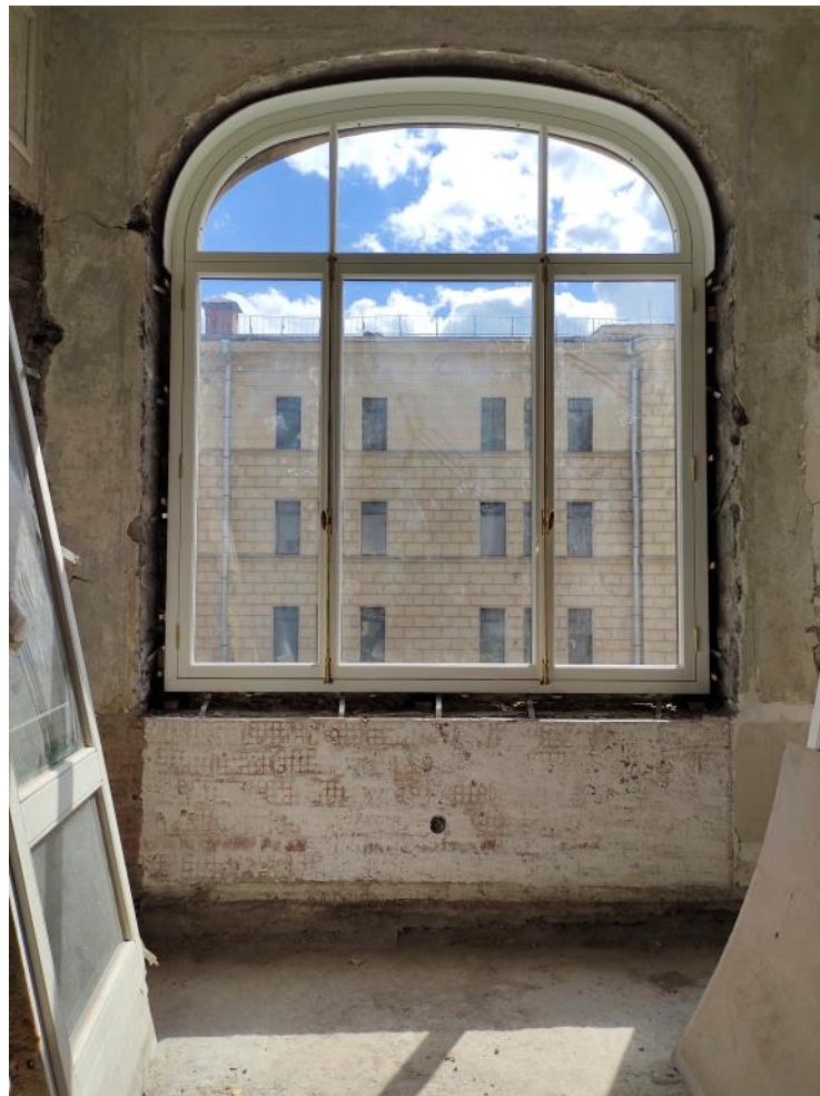
27. Объект культурного наследия регионального значения «Доходный дом А.П. Мещерского» (г. Санкт-Петербург, Кирочная ул., д. 22, лит. А). Помещение кв. №2.
