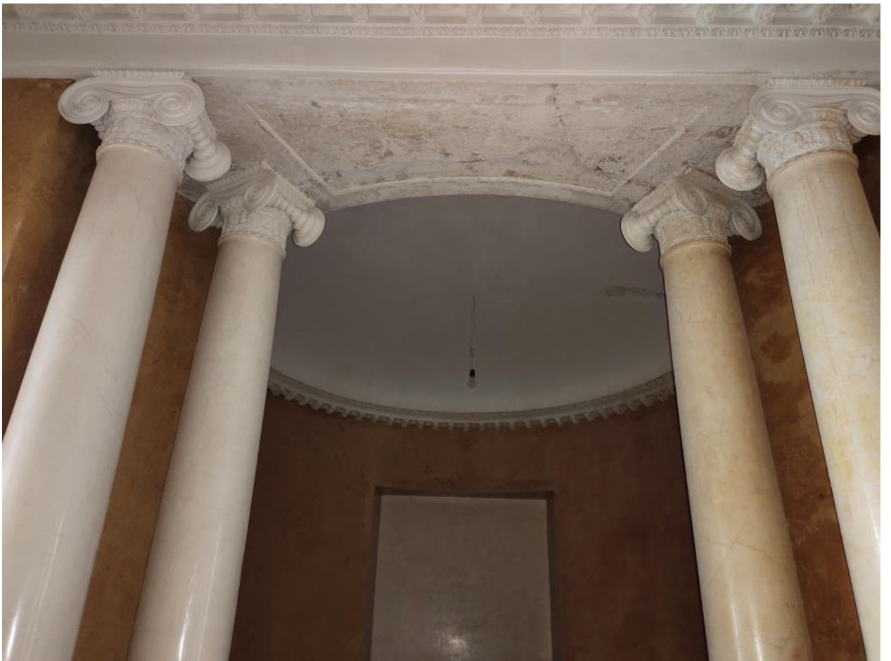
35. Объект культурного наследия регионального значения «Доходный дом А.П. Мещерского» (г. Санкт-Петербург, Кирочная ул., д. 22, лит. А). Помещение кв. №2.
