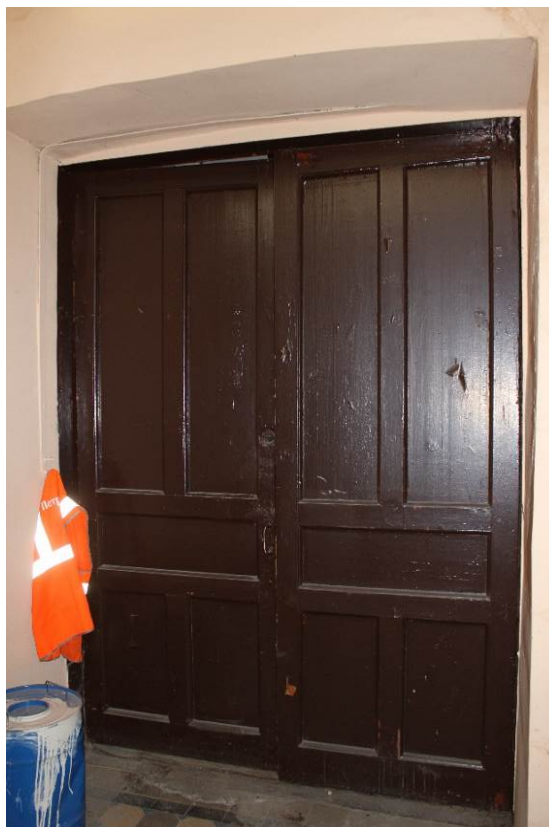
Фото 37. Объект культурного наследия регионального значения «Железнодорожная станция Левашово: вокзал» по адресу: г. Санкт-Петербург, п. Левашово, Железнодорожная ул., д. 7, лит. А (Левашово, железнодорожная станция. Вокзальное шоссе, 43). Вид на деревянную дверь в помещении №1. Дата: 28.11.2022 г.
