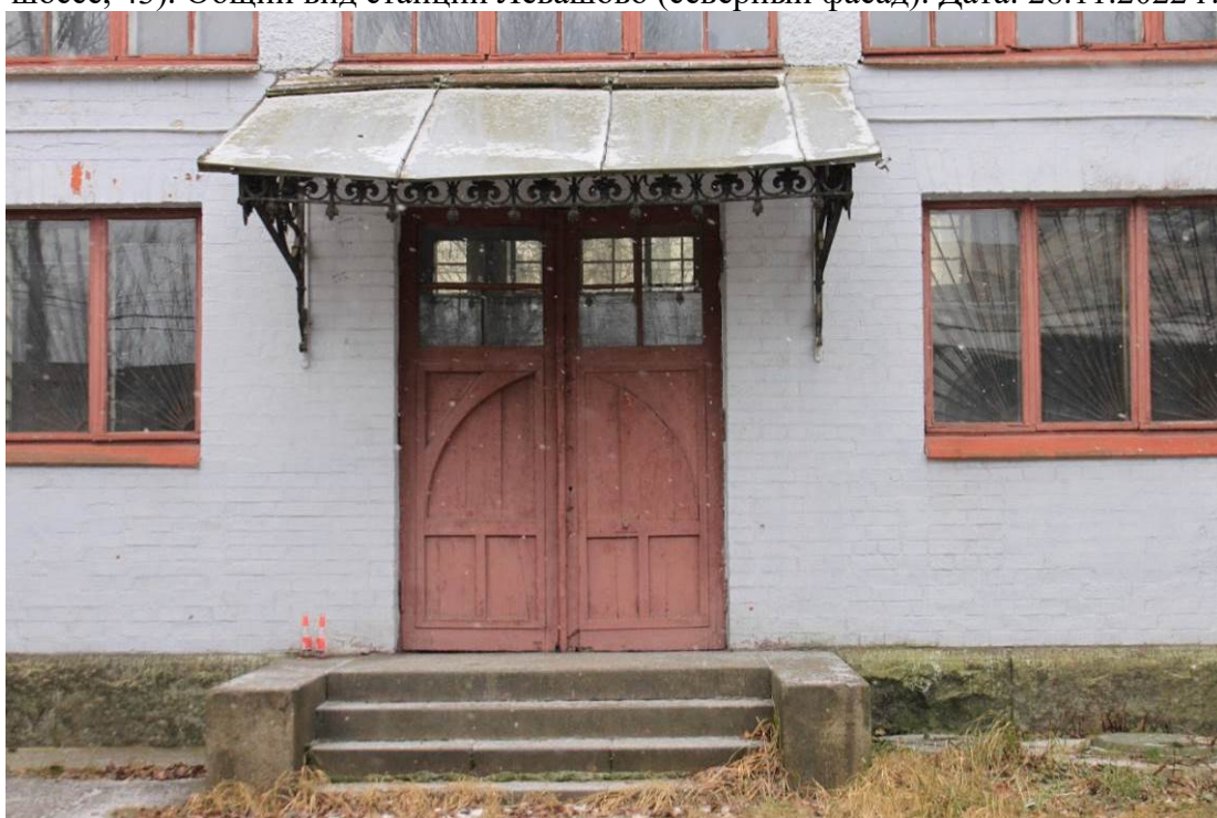
Фото 12. Объект культурного наследия регионального значения «Железнодорожная станция Левашово: вокзал» по адресу: г. Санкт-Петербург, п. Левашово, Железнодорожная ул., д. 7, лит. А (Левашово, железнодорожная станция. Вокзальное шоссе, 43). Вид на исторический козырек и деревянную дверь, являющиеся предметом охраны (северный фасад). Дата: 28.11.2022 г.
