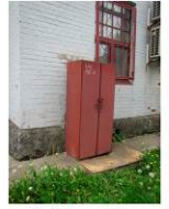
Вводной шкаф N1
