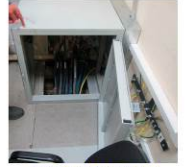
Сщ. шкафы в помещении связевой
