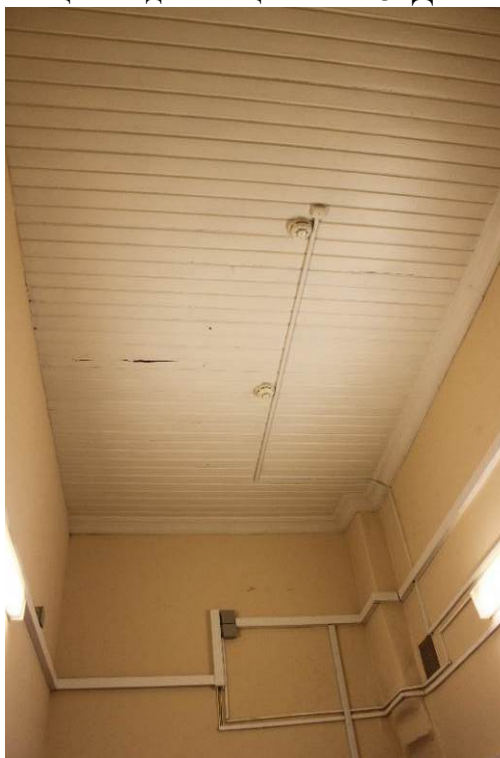
Фото 2. Объект культурного наследия регионального значения «Железнодорожная станция Левашово: вокзал» по адресу: г. Санкт-Петербург, п. Левашово, Железнодорожная ул., д. 7, лит. А (Левашово, железнодорожная станция. Вокзальное шоссе, 43). Вид на обшивку потолка в помещении №13, являющуюся предметом охраны Дата: 28.11.2022г.
