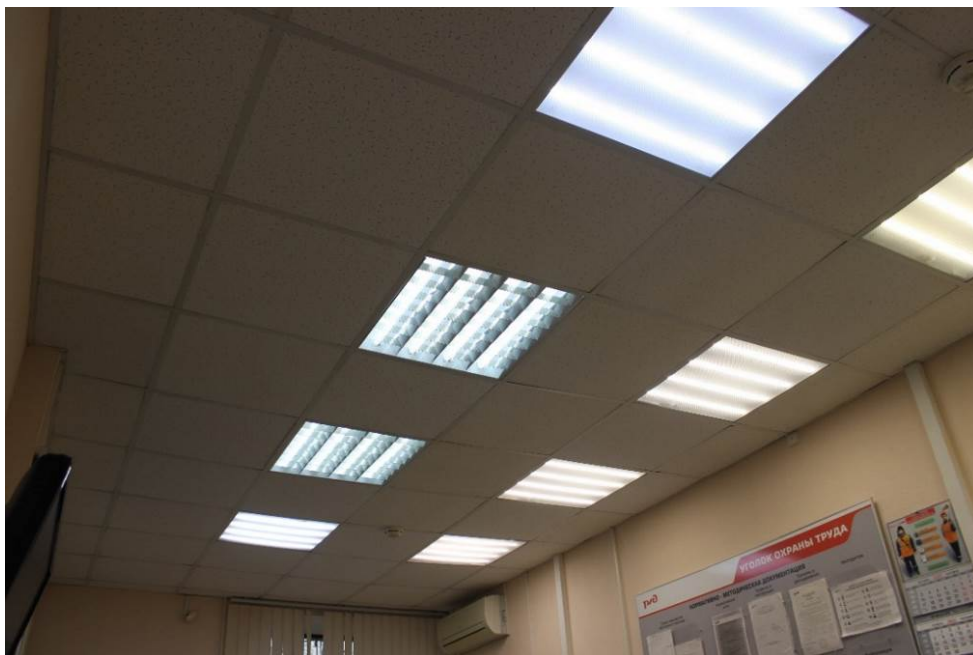
Фото 7. Объект культурного наследия регионального значения «Железнодорожная станция Левашово: вокзал» по адресу: г. Санкт-Петербург, п. Левашово, Железнодорожная ул., д. 7, лит. А (Левашово, железнодорожная станция. Вокзальное шоссе, 43). Вид на зашитый потолок в помещении №15. Дата: 28.11.2022 г.
