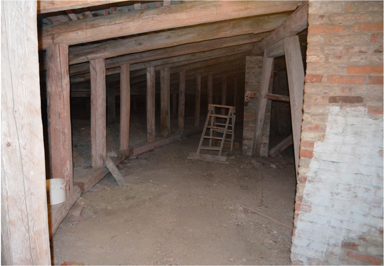
Фото 20. ОКН федерального значения «Кавальер Анны Иоанновны». Чердак. Стропильная система. Фрагмент. Съёмка 24.07.2023 г.
