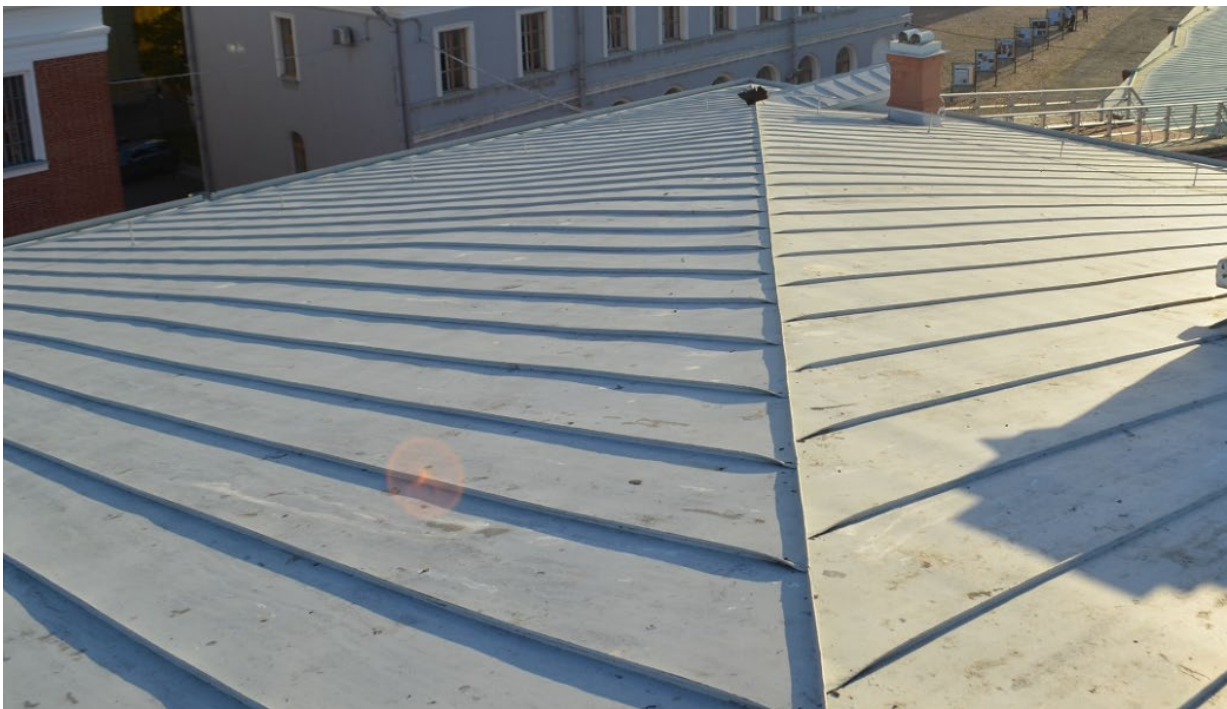
Фото 07. ОКН федерального значения «Кавальер Анны Иоанновны». Крыша. Фрагмент. Съёмка 24.07.2023 г.
