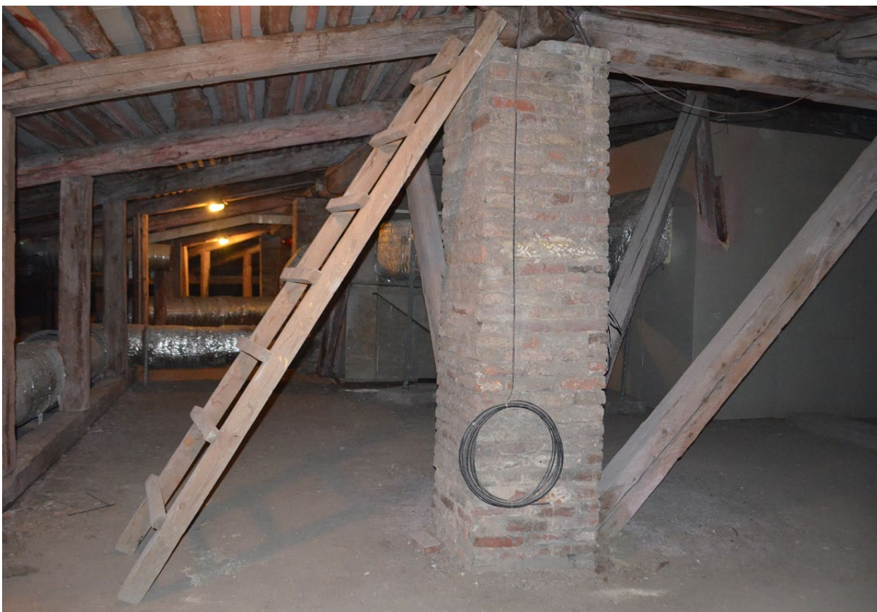
Фото 12. ОКН федерального значения «Кавальер Анны Иоанновны». Чердак. Стропильная система. Фрагмент. Съёмка 24.07.2023 г.
