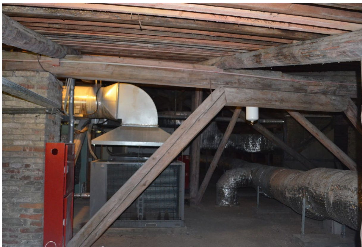
Фото 17. ОКН федерального значения «Кавальер Анны Иоанновны». Чердак. Стропильная система. Фрагмент. Съёмка 24.07.2023 г.
