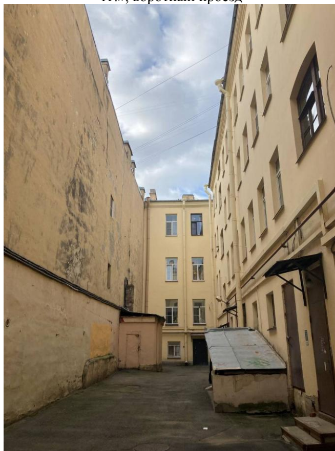
Фото 6. Фрагмент дворового фасада объекта культурного наследия регионального значения «Дом, в котором жили: Попов Александр Степанович в 1901-1902 гг., Козлов Петр Кузьмич в 1903-1905
