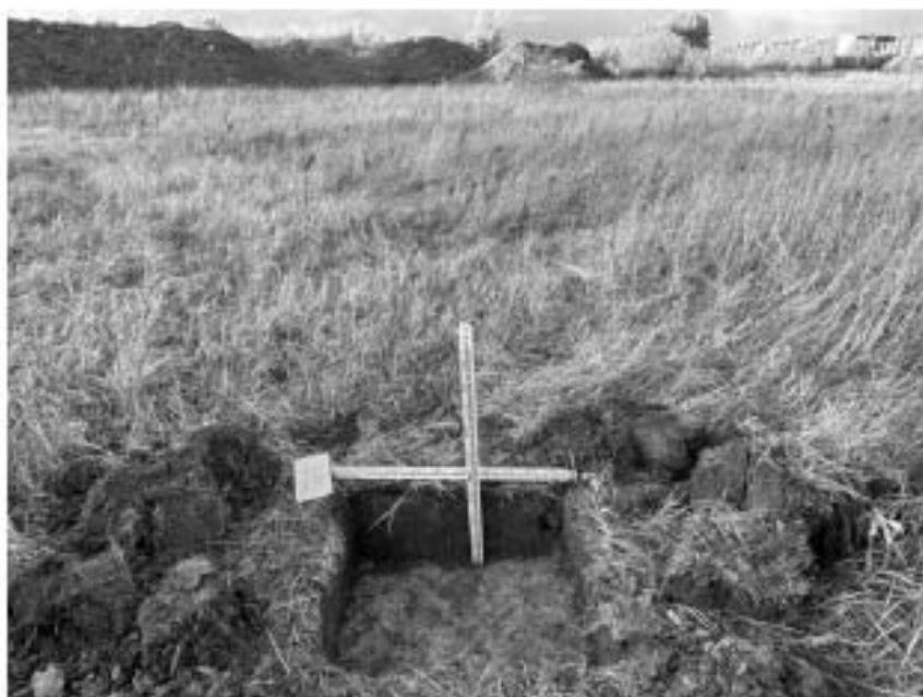
Илл. 123. г. Пушкин. Территория обследования. Шурф 16 по завершении земляных работ. Вид с юга.
