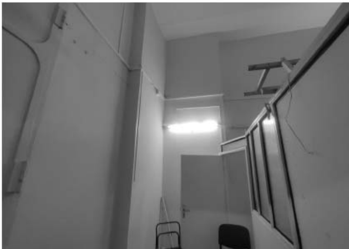
46. Объект культурного наследия федерального значения «Банк», расположенный по адресу: г. Санкт-Петербург, наб. кан. Грибоедова, д. 30-32, лит. А, входящий в состав объекта культурного наследия федерального значения «Банк Ассигнационный». Фрагмент пом. 60-Н (12) в уровне 1-го этажа.
