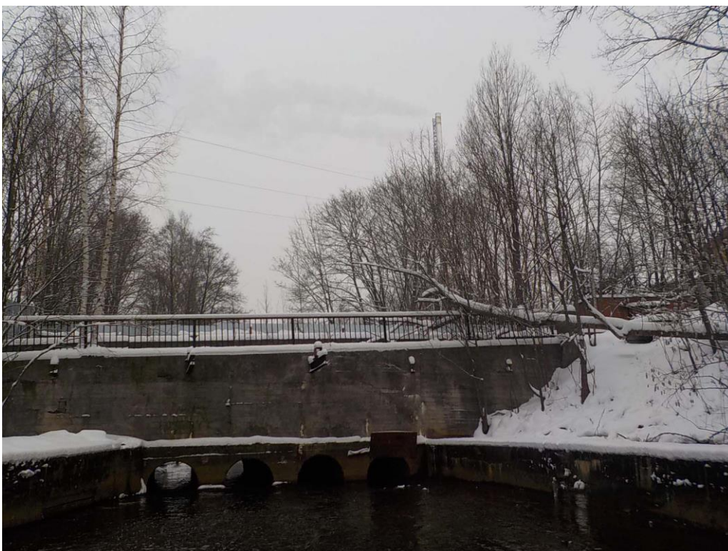
3. «Соляной канал», в составе объекта культурного наследия регионального значения «Ансамбль Сестрорецкого оружейного завода», г. Санкт-Петербург, г. Сестрорецк, ул. Воскова, д. 2, лит. А, сооружение 3. Фрагмент канала. Фото 01.02.2024г.
