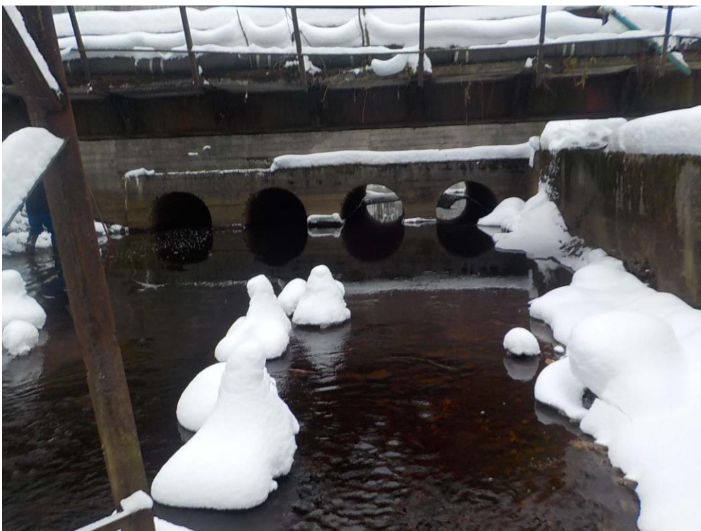
7. «Соляной канал», в составе объекта культурного наследия регионального значения «Ансамбль Сестрорецкого оружейного завода», г. Санкт-Петербург, г. Сестрорецк, ул. Воскова, д. 2, лит. А, сооружение 3. Фрагмент канала. Фото 01.02.2024г.
