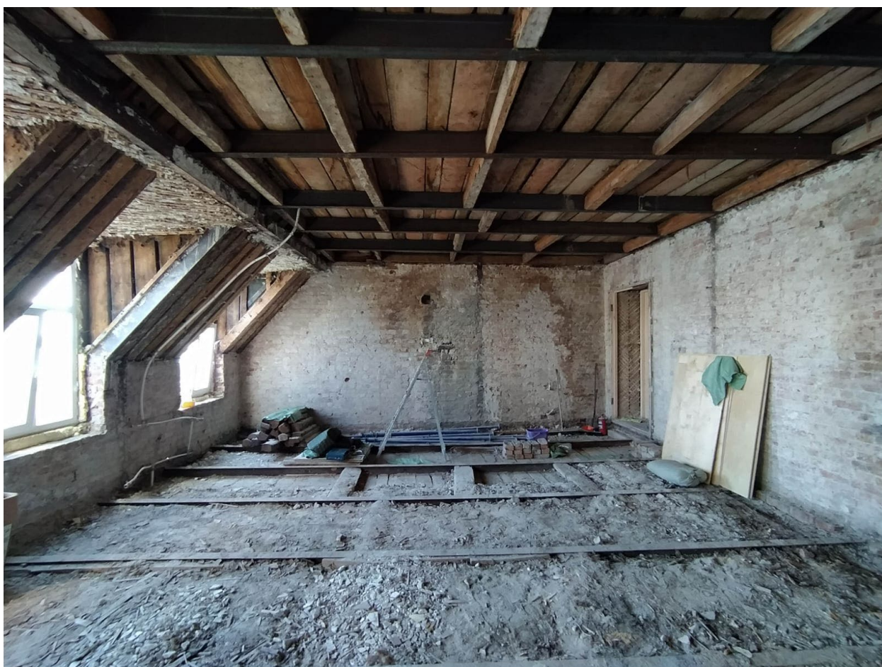
10. Помещения №№13, 14 квартиры №10 в уровне мансардного этажа выявленного объекта культурного наследия «Дом М.Д. Корнилова», расположенного по адресу: г. Санкт-Петербург, Малый проспект П.С., д. 26-28, литера А. 24.11.2023.
