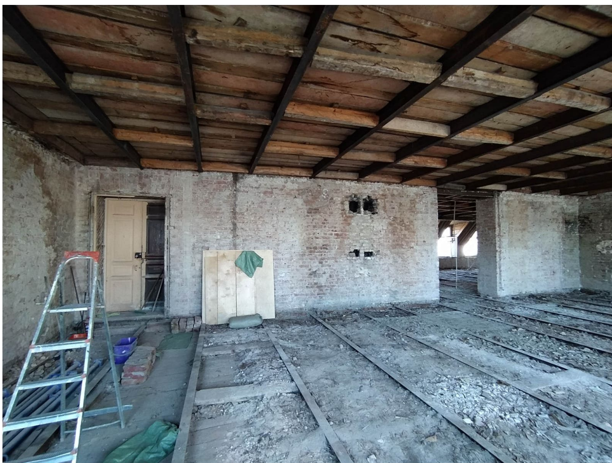
9. Помещения №№13, 14 квартиры №10 в уровне мансардного этажа выявленного объекта культурного наследия «Дом М.Д. Корнилова», расположенного по адресу: г. Санкт-Петербург, Малый проспект П.С., д. 26-28, литера А. 24.11.2023.
