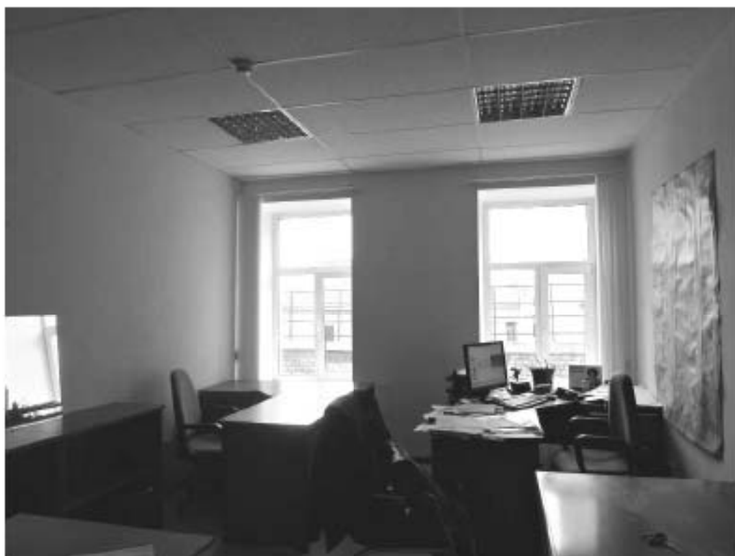
301. «Дом Н.Я. и Ф.Я. Колобова». Санкт-Петербург, Большой пр. П.С., 16-18; Красного курсанта ул., д.1; Пионерская ул., д.6, литера А. Большой пр. П.С., 18. 5-й этаж. Фрагмент помещения 16-Н. Фото: 21.03.2023.
