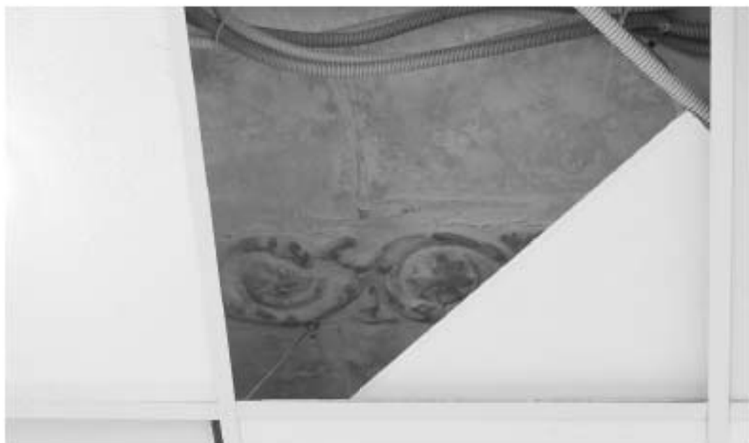
54. «Дом Н.Я. и Ф.Я. Колобова». Санкт-Петербург, Большой пр. П. С., 16-18; Красного курсанта ул., д.1; Пионерская ул., д.6, литера А. Большой пр. П. С., 18. 2-й этаж. Помещение 6-Н. Фрагмент потолка. Фото: 21.03. 2023.
