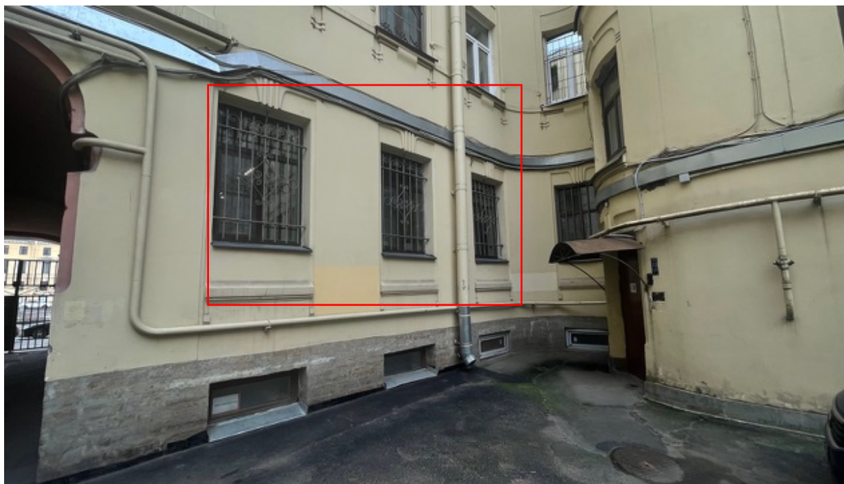
2. Вид на дворовой фасад объекта культурного наследия регионального значения «Дом кн.Э.Н.Юсуповой с флигелями и фонтаном во дворе. 1902-1904 гг., арх.Л.В.Шмеллинг» и окна помещения;
