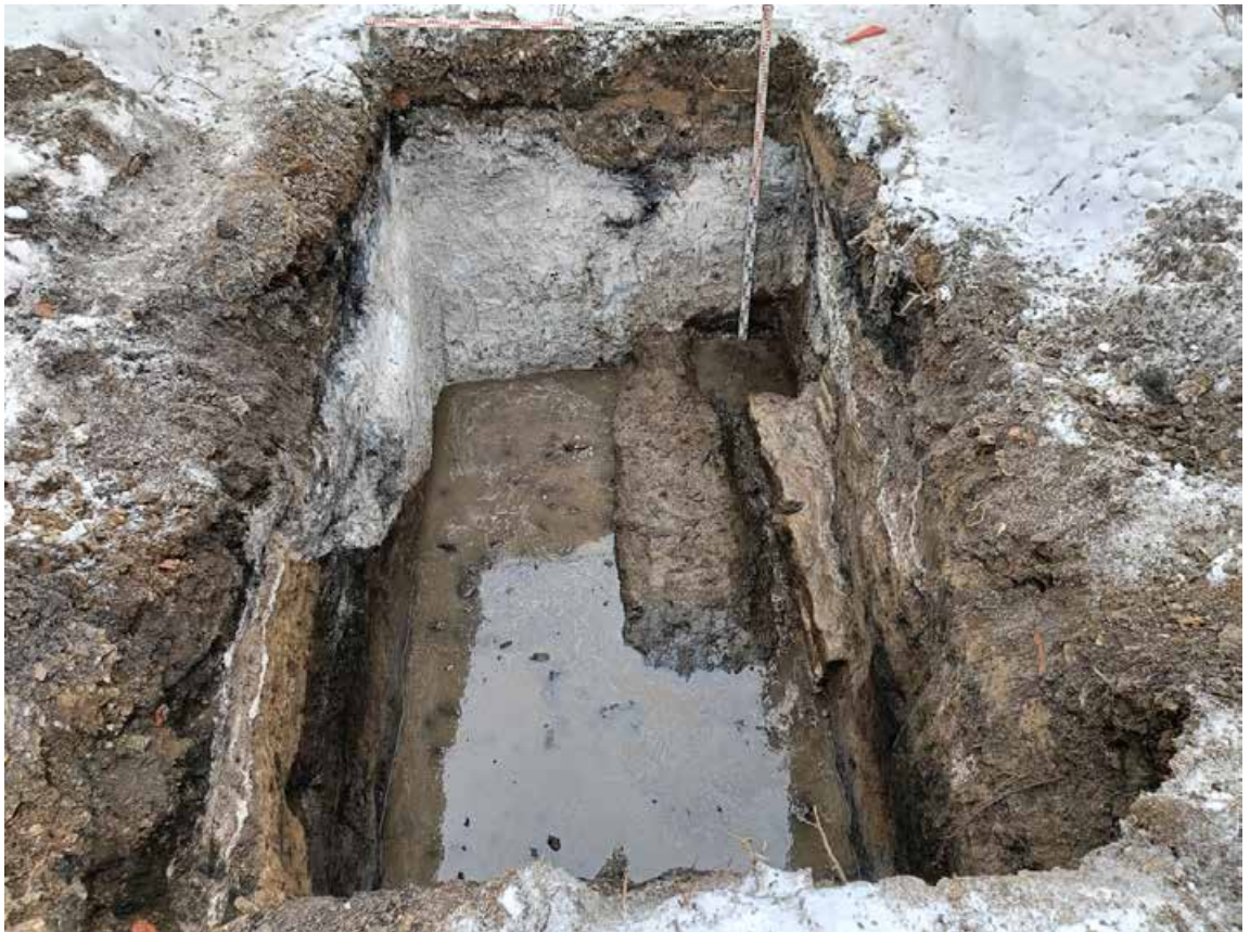
Рис. 69. СПб-2024. Октябрьская наб., 38. Шурфы 1-2, фиксация по уровню окончания работ, вид на юго-восток.
