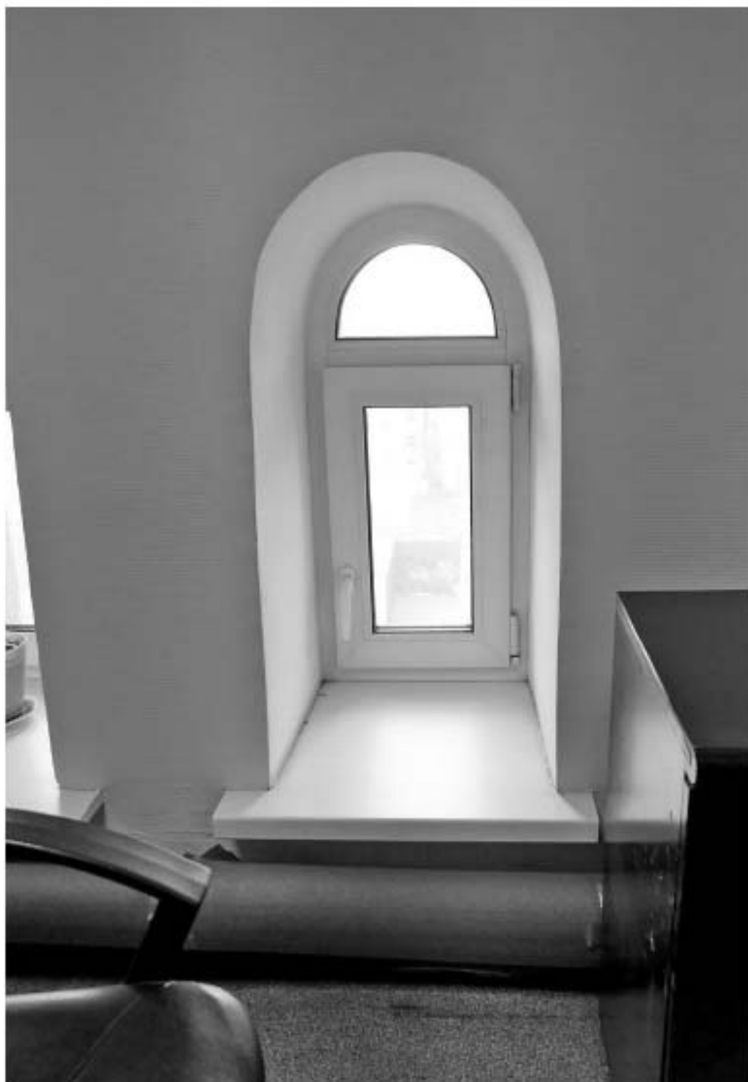
312. «Дом Н.Я. и Ф.Я. Колобовых». Санкт-Петербург, Большой пр. П.С., 16-18; Красного курсанта ул., д.1; Пионерская ул., д.6, литера А. Большой пр. П.С., 18. 6-й этаж. Фрагмент помещения 11-Н. Оконный проем. Фото: 21.03. 2023.
