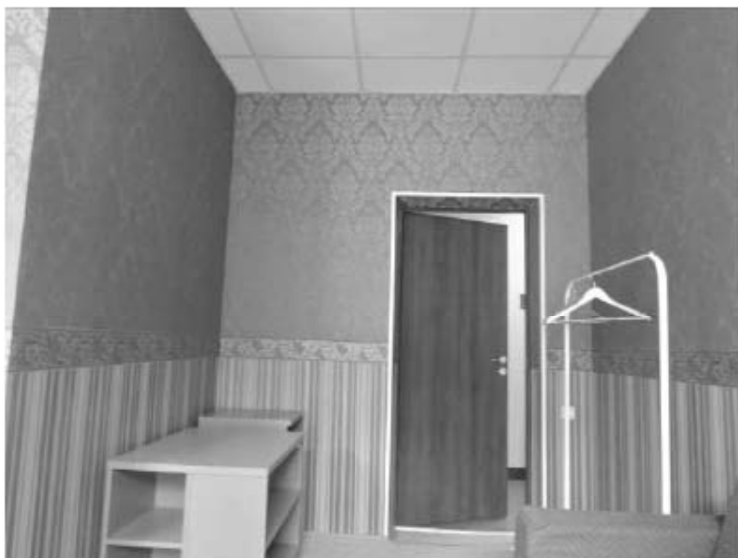
296. «Дом Н.Я. и Ф.Я. Колобова». Санкт-Петербург, Большой пр. П.С., 16-18; Красного курсанта ул., д.1; Пионерская ул., д.6, литера А. Большой пр. П.С., 18. 5-й этаж. Фрагмент помещения 16-Н. Фото: 21.03.2023.
