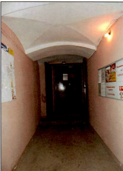
Фото 29. Интерьер (лестница Л-1).
